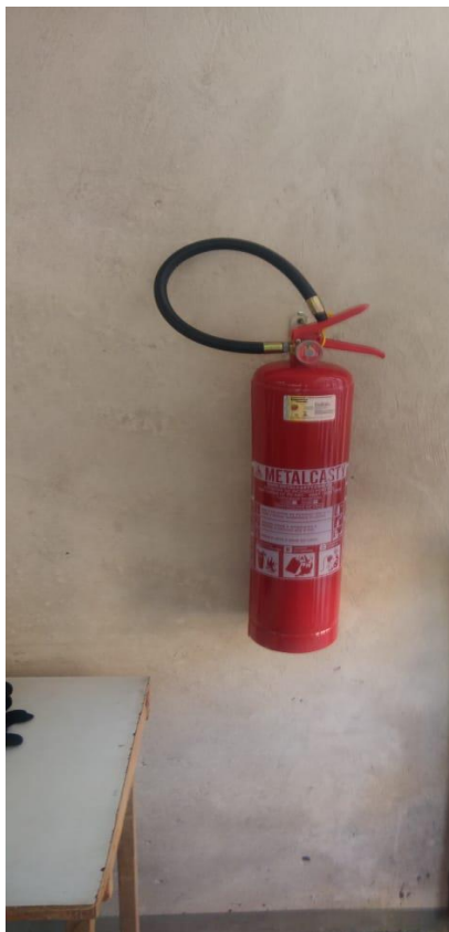
Figura 09. Extintor Classe ABC – Pó químico, adquirido após estudo. Fonte: Próprio autor.
