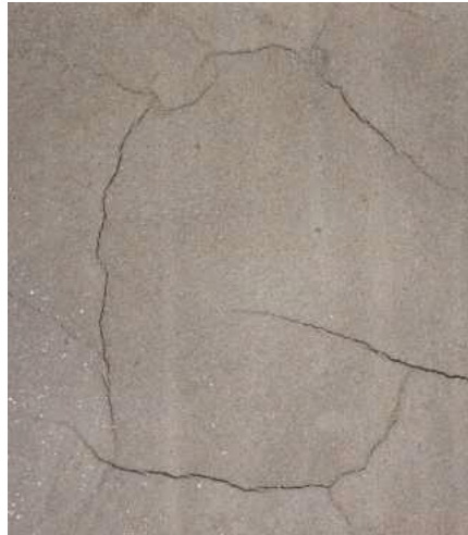
Figura 8 - Fissuras causadas por retração.
