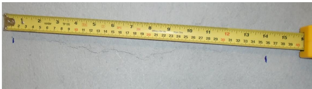
Figura 57 - Fissura detectada no painel de composição do T-III. Fonte: Autoria própria (2016).
