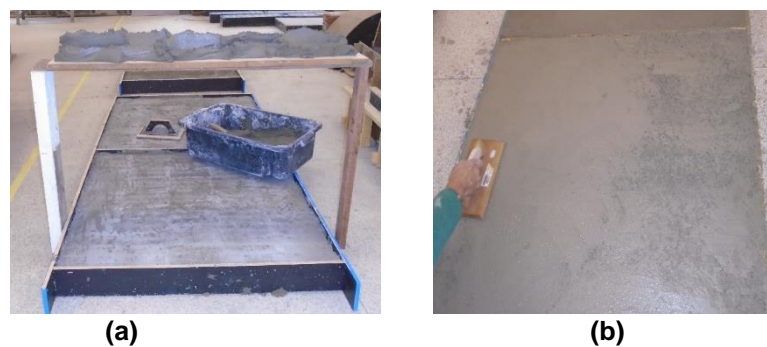
Figura 28 - (a) altura de queda do reboco, (b) alisamento do reboco.
