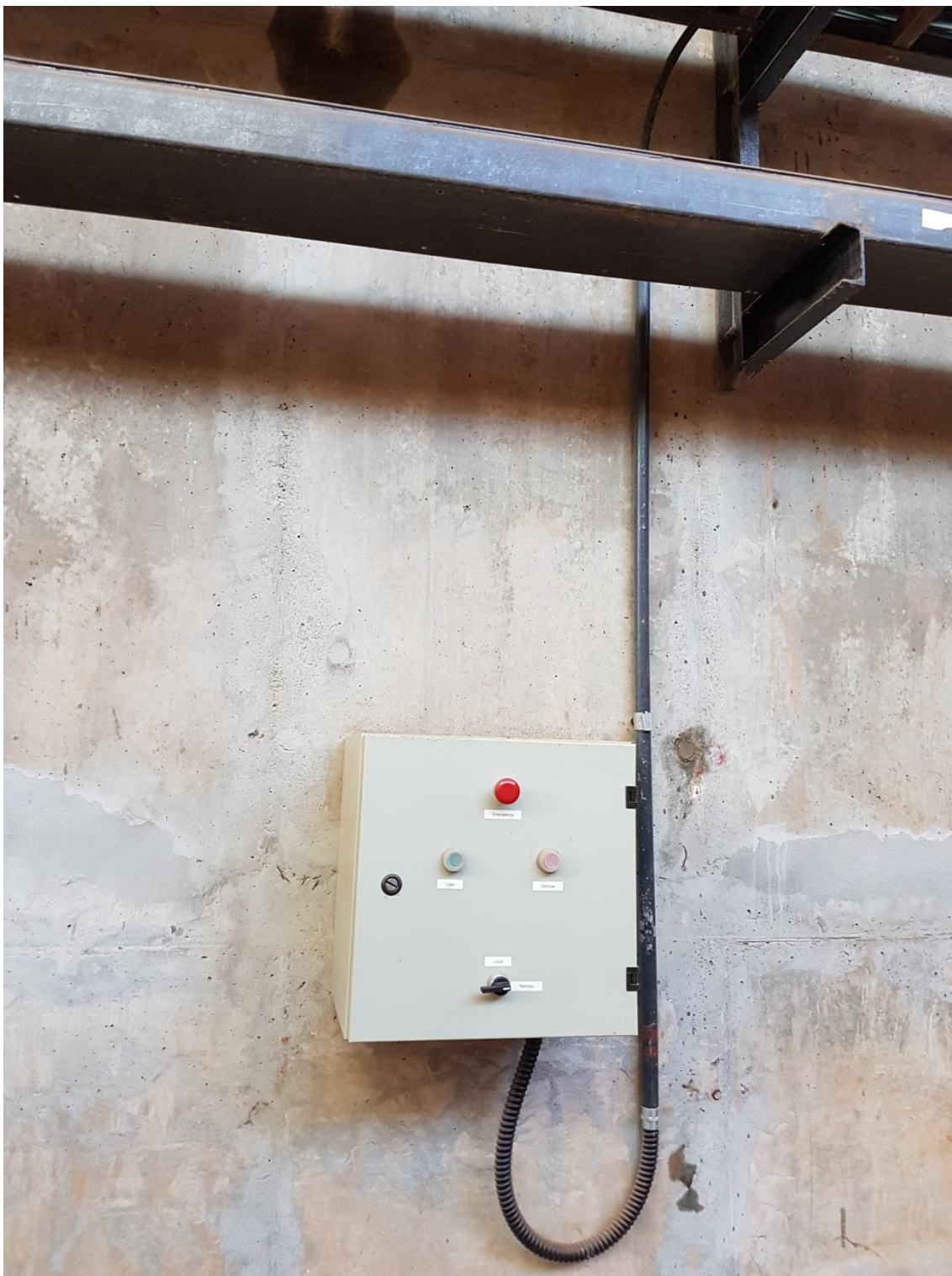
Fotografia 4: Painel local/remoto. Fonte: (Casa de Bombas ETA Klabin, 2016).
