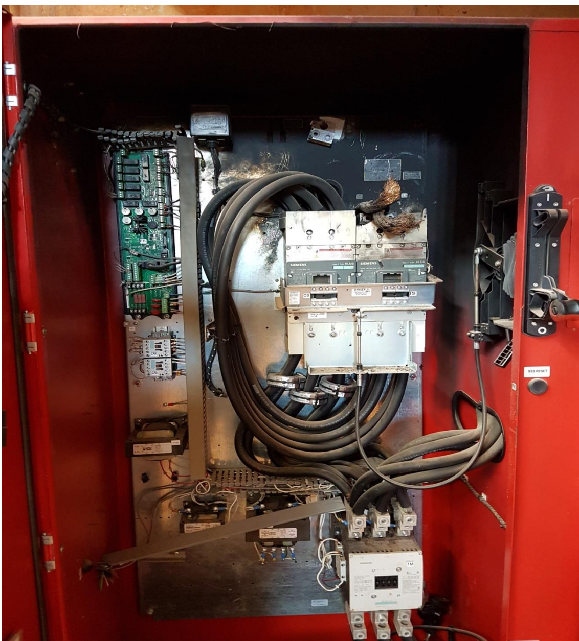
Fotografia 1: Painel de bombas de emergência danificado. Fonte: (Casa de Bombas ETA Klabin, 2016).
