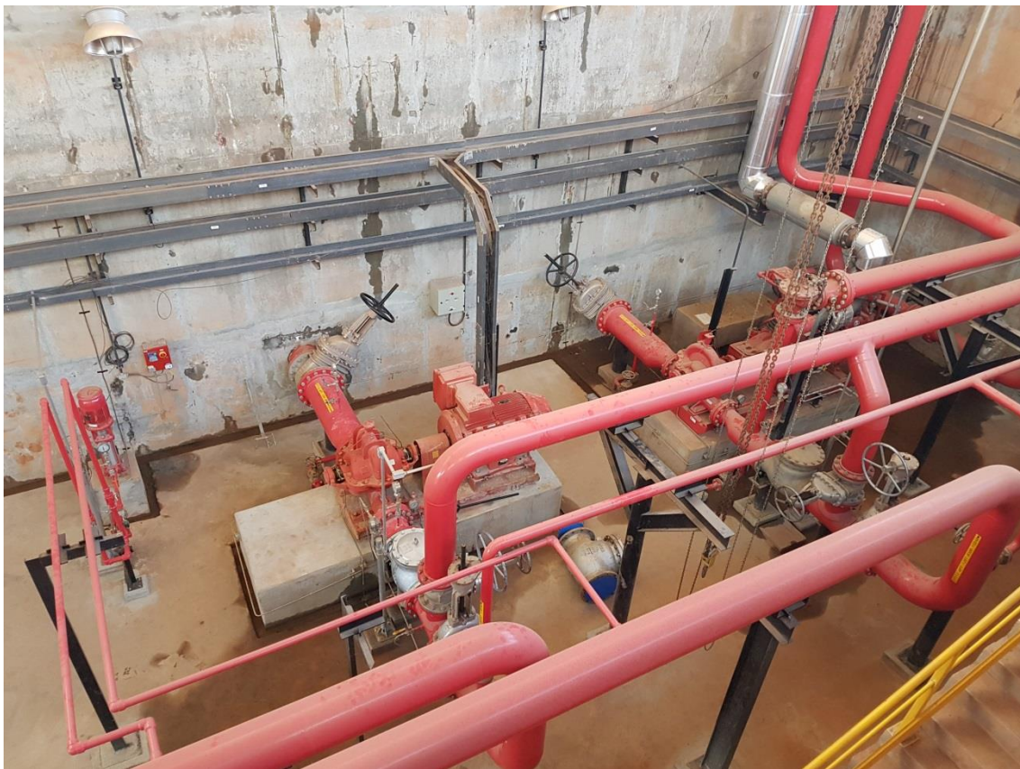
Fotografia 6: Visão geral de Casa de Bombas. Fonte: (Casa de Bombas ETA Klabin. 2016).
