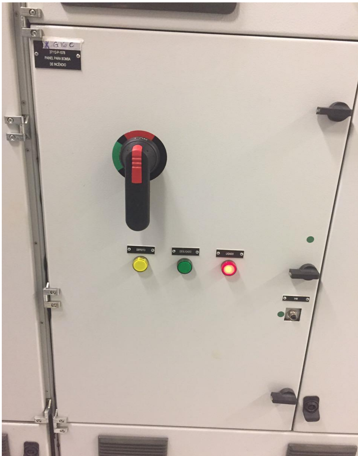
Fotografia 2: Gaveta de potência da bomba de incêndio. Fonte: (Sala Elétrica ETA Klabin, 2016).
