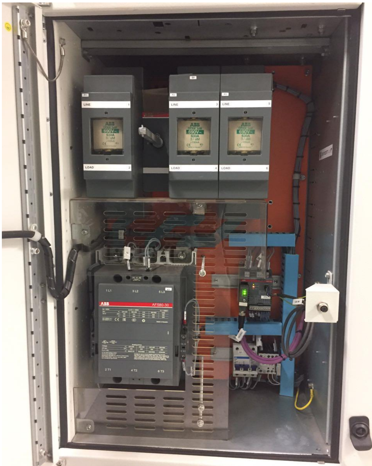
Fotografia 3: Parte interna da gaveta de potência da bomba de incêndio. Fonte: (Sala elétrica ETA Klabin, 2016).
