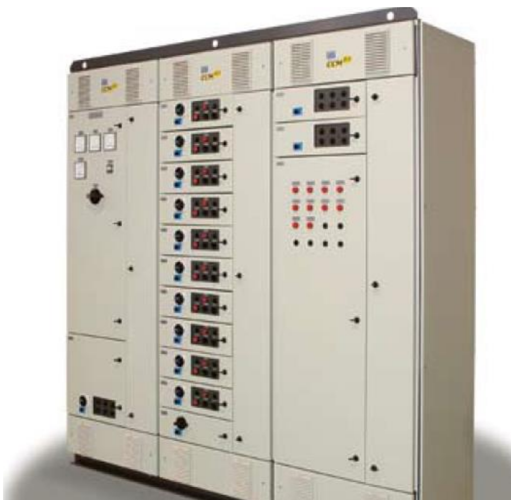
Figura 4: Centro de Controle de Motores de Baixa Tensão. Fonte: (WEG, Manual Técnico, 2016).
