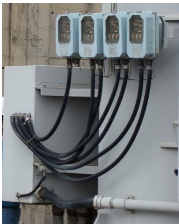
Figura 8: Termômetros analógicos para transformadores Fonte: Engº Wilson R. Baccega – CTEEP
