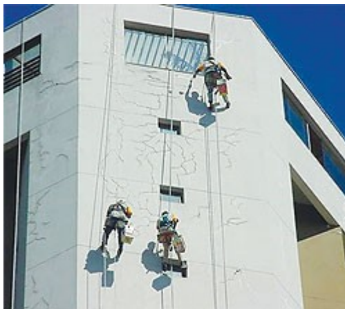
Figura 4: Fissuras decorrentes de retração por secagem em fachada
