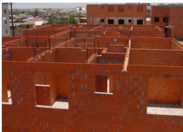
Figura 1: Elementos do sistema de vedação de alvenaria estrutural antes da execução do revestimento
