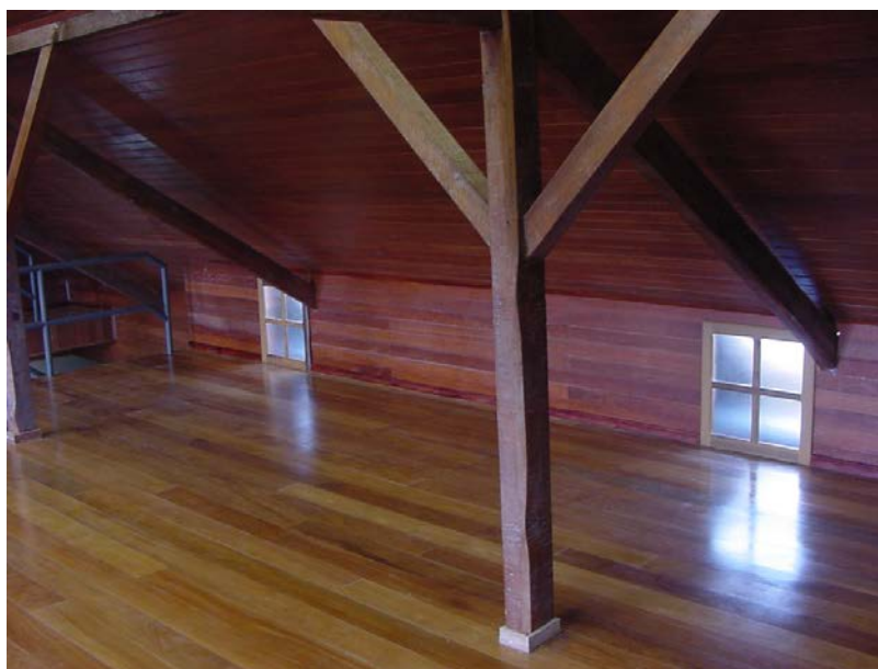
Figura 139: Telhado adaptado para adaptação do novo uso - Hospital Psiquiátrico Nossa Senhora da Luz dos Pinhais
