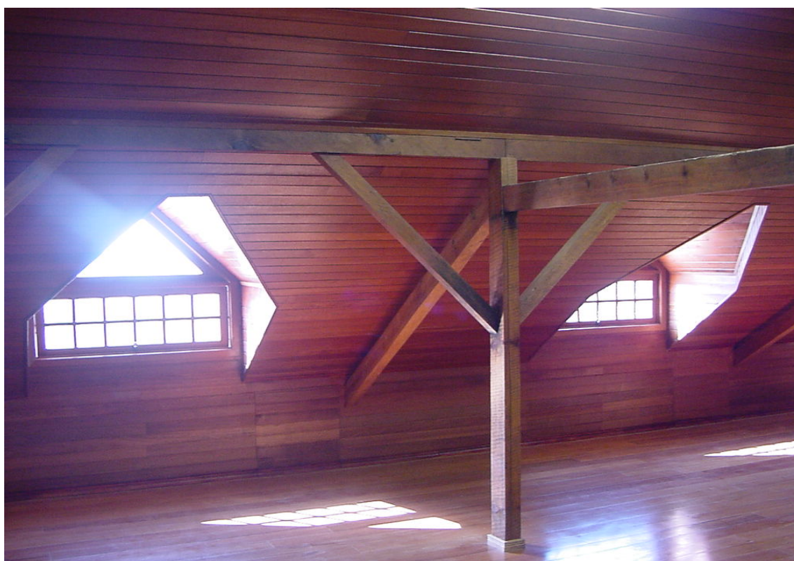
Figura 141: Mansardas para iluminação do ático - Hospital Psiquiátrico Nossa Senhora da Luz dos Pinhais Fonte: Autor.
