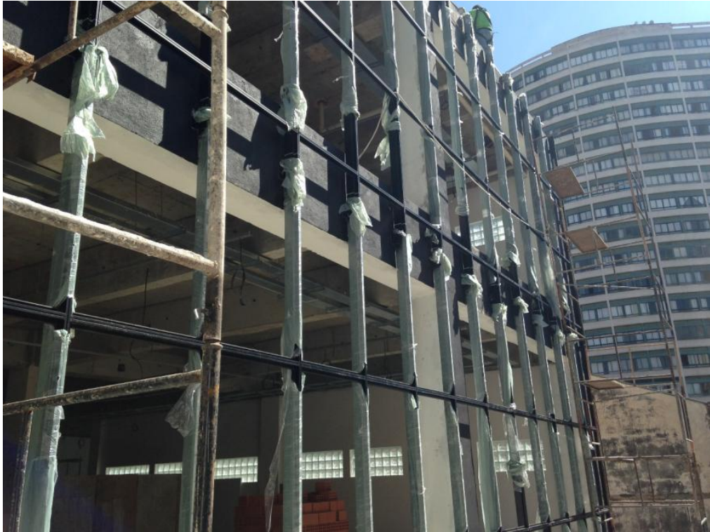
Figura 83: Fachada do anexo com pele de vidro, prejudicando o conforto ambiental – Ferragens Hauer
