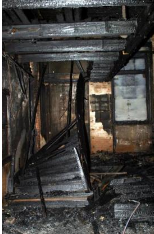
Figura 65: Foto do interior após o incêndio – Ferragens Hauer Fonte: Instituto de Planejamento e Pesquisa Urbana de Curitiba IPPUC (1998).
