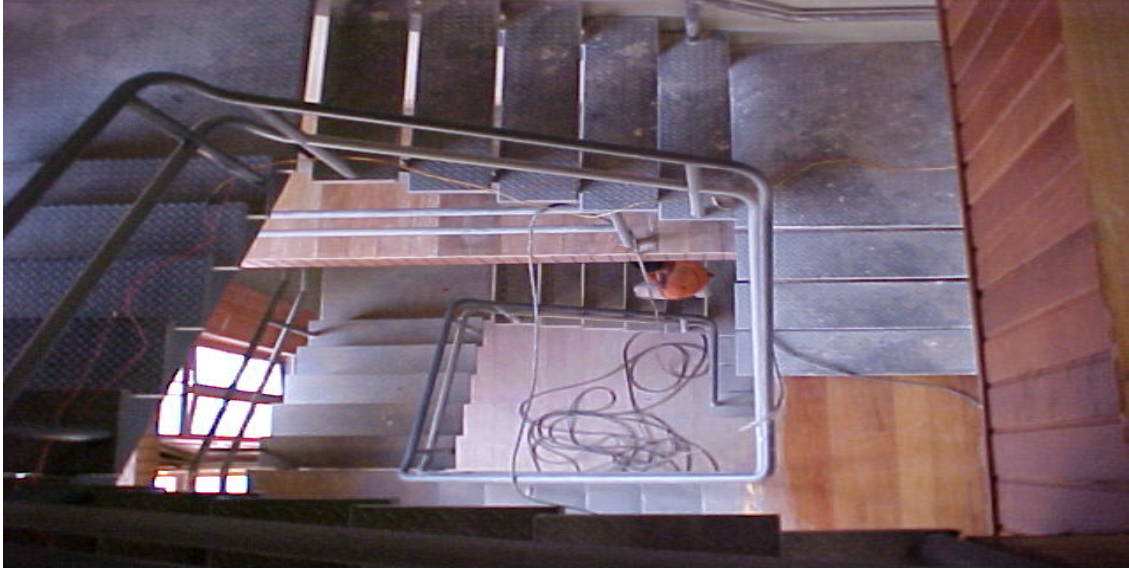
Figura 136: Adaptação do edifício ao novo uso, execução de escada metálica - Hospital Psiquiátrico Nossa Senhora da Luz dos Pinhais
