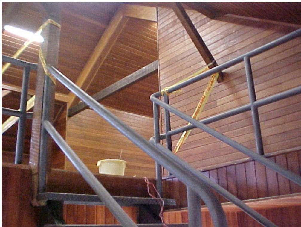
Figura 140: Escada metálica para acesso ao ático - Hospital Psiquiátrico Nossa Senhora da Luz dos Pinhais Fonte: Autor.
