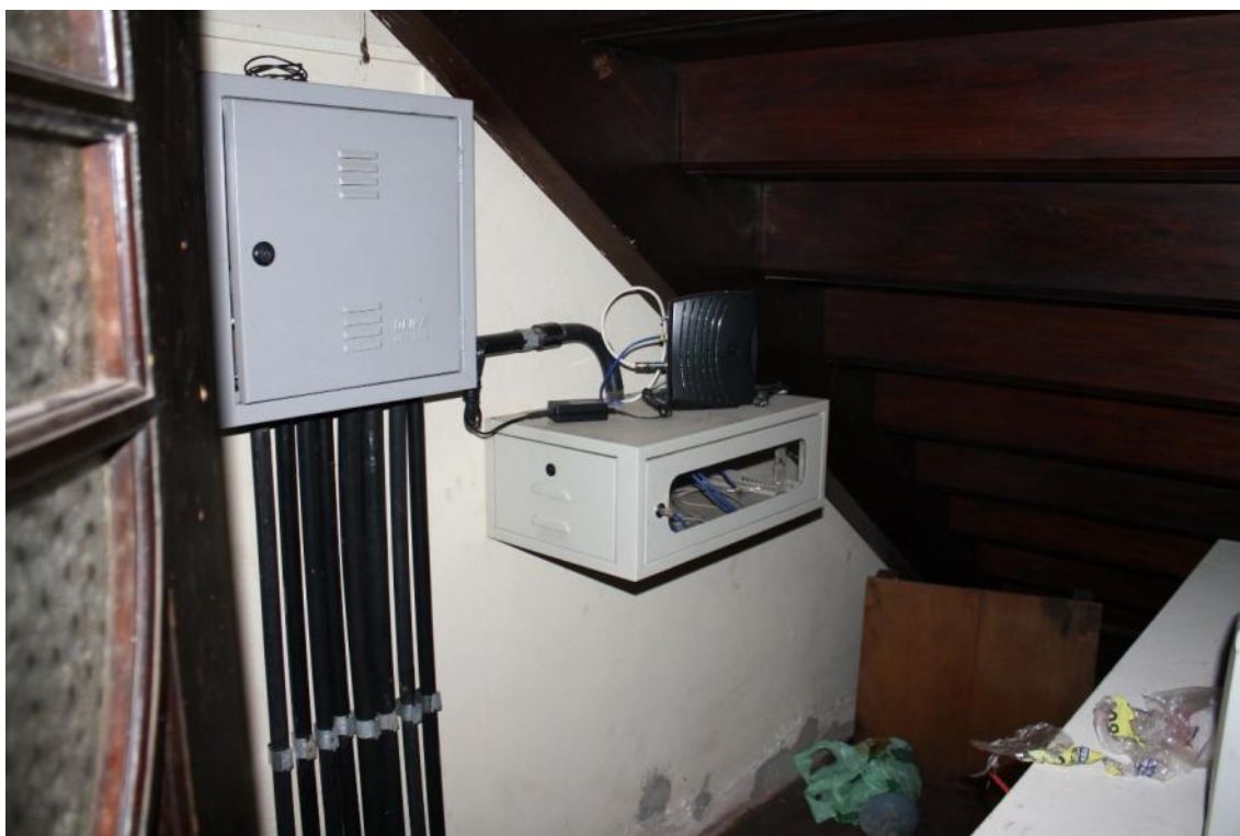
Figura 96: Adaptação elétrica para o novo uso - Residência Vila Sophia
