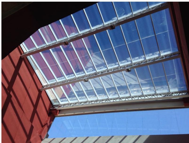
Figura 76: Fechamento do átrio interno – Ferragens Hauer Fonte: Autor.
