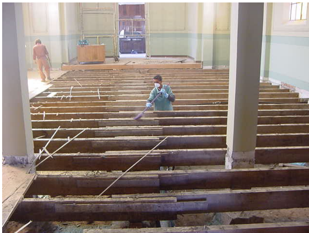
Figura 132: Restauro do piso da capela - Hospital Psiquiátrico Nossa Senhora da Luz dos Pinhais
