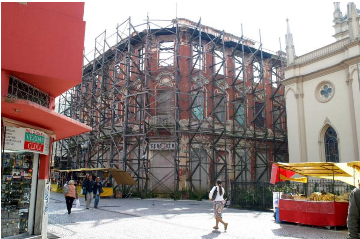
Figura 66: Foto da estrutura restante após incêndio e abandono – Ferragens Hauer Fonte: Wachowicz (1980).
