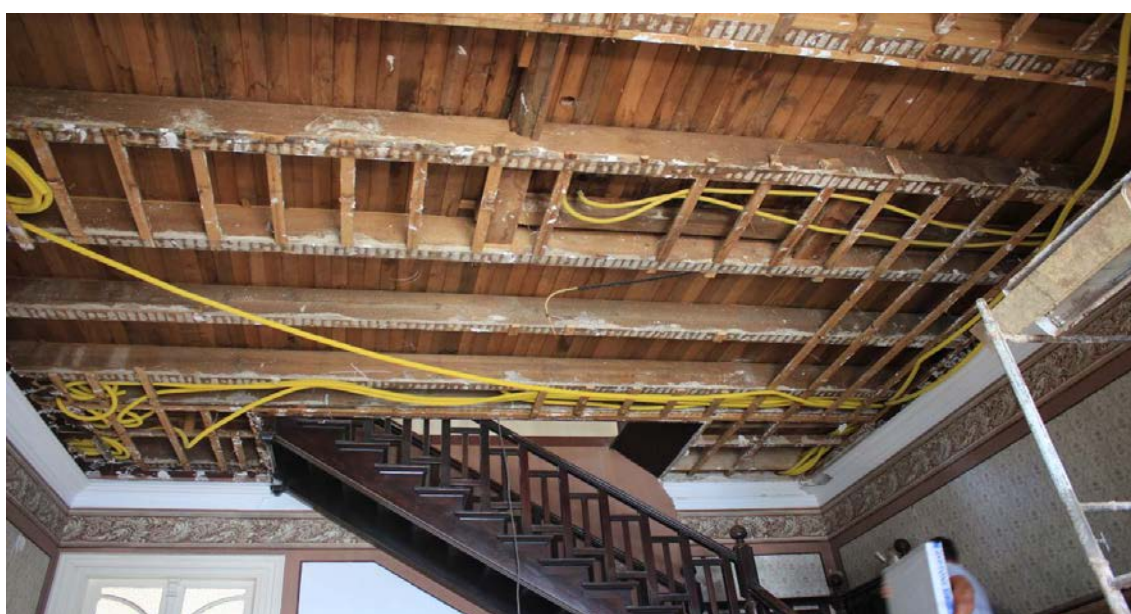
Figura 97: Nova infraestrutura elétrica - Residência Vila Sophia
