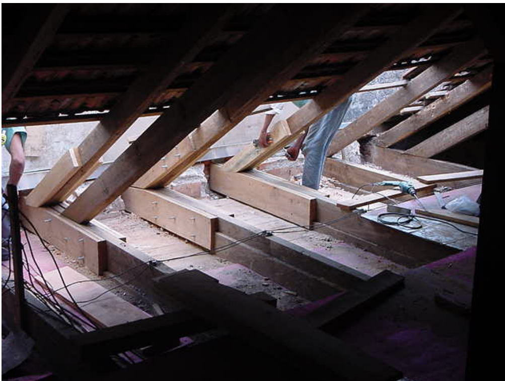
Figura 123: Execução de reforço no restauro do telhado - Hospital Psiquiátrico Nossa Senhora da Luz dos Pinhais
