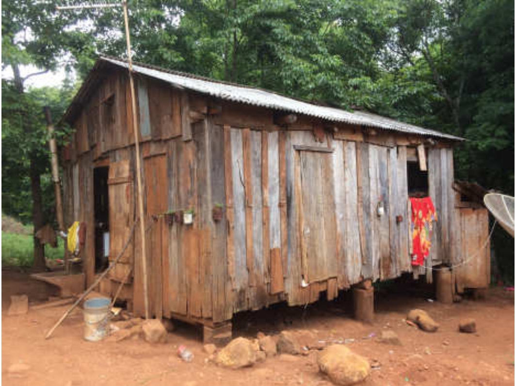
Figura 21 - UH (b) em situação de precariedade
