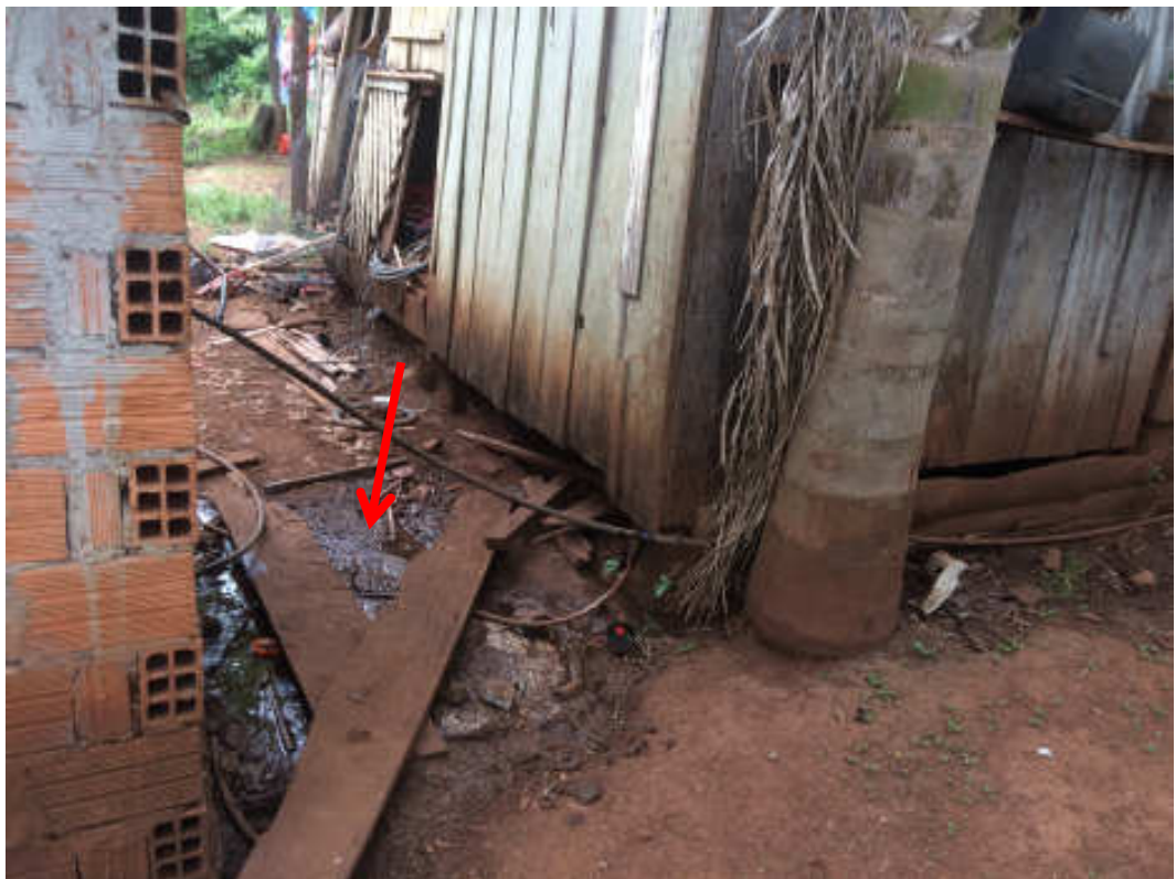
Figura 35 - Lançamento a céu aberto do esgoto do banheiro
