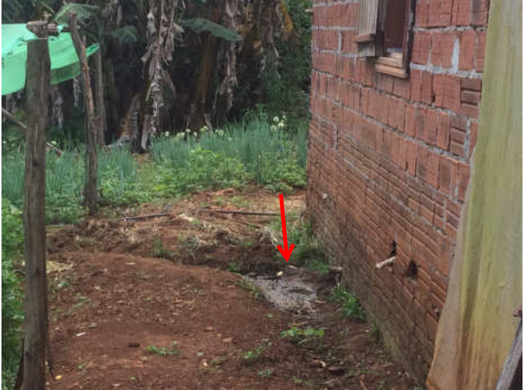
Figura 39 - Esgoto da cozinha e do banheiro direcionado para a horta e pomar
