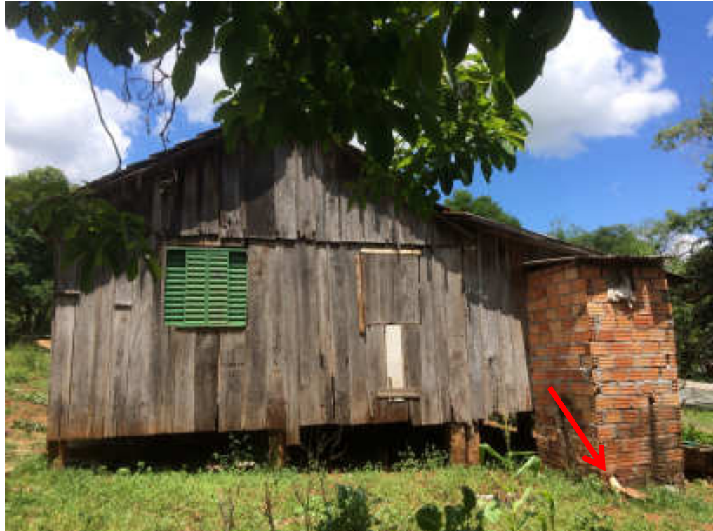
Figura 36 - Lançamento a céu aberto do esgoto do banheiro
