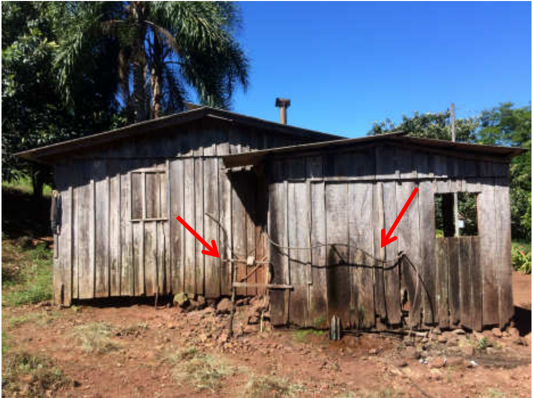
Figura 28 - Tubulação hidráulica aparente (a)
