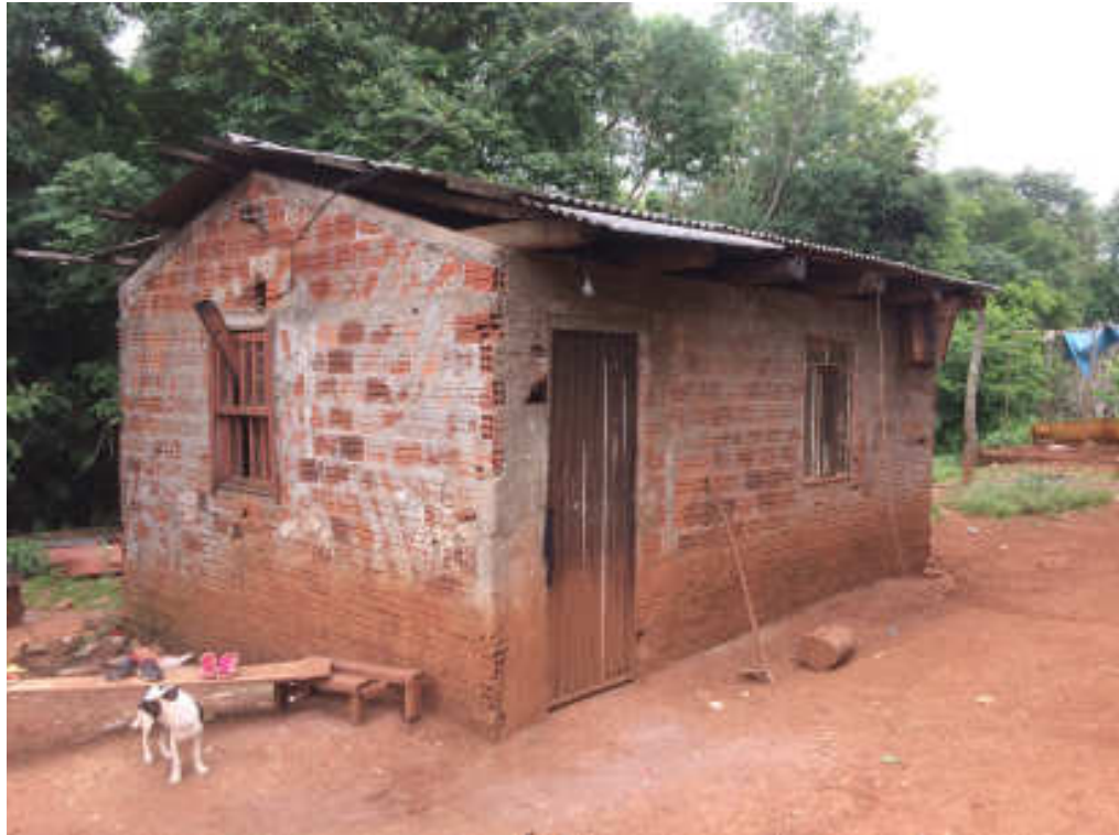
Figura 19 - UH (a) em situação de precariedade
