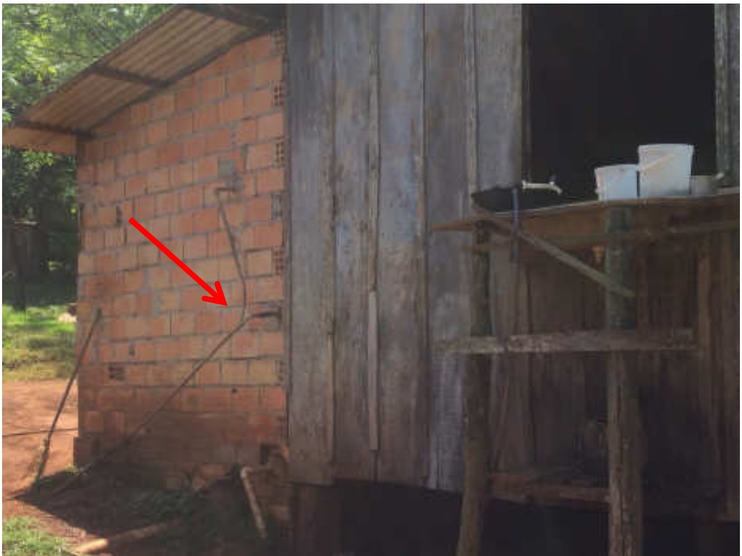
Figura 29 - Tubulação hidráulica aparente (b)
