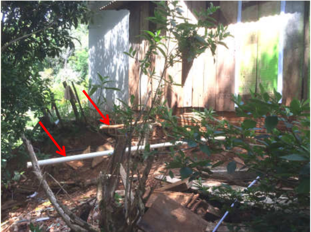
Figura 38 - Lançamento a céu aberto do esgoto da lavanderia e da cozinha
