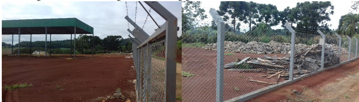
Figura 31 – Central de Triagem de RCC da Engegreen na Vila Rio Tuna – Francisco Beltrão
