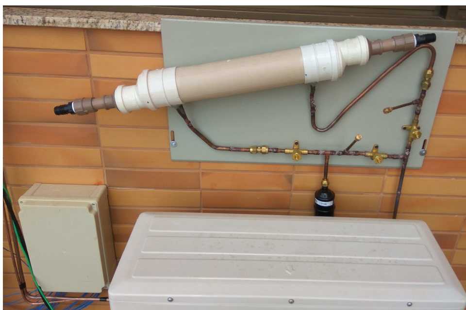
Figura 12 - Trocador de calor instalado em série com a unidade condensadora.
