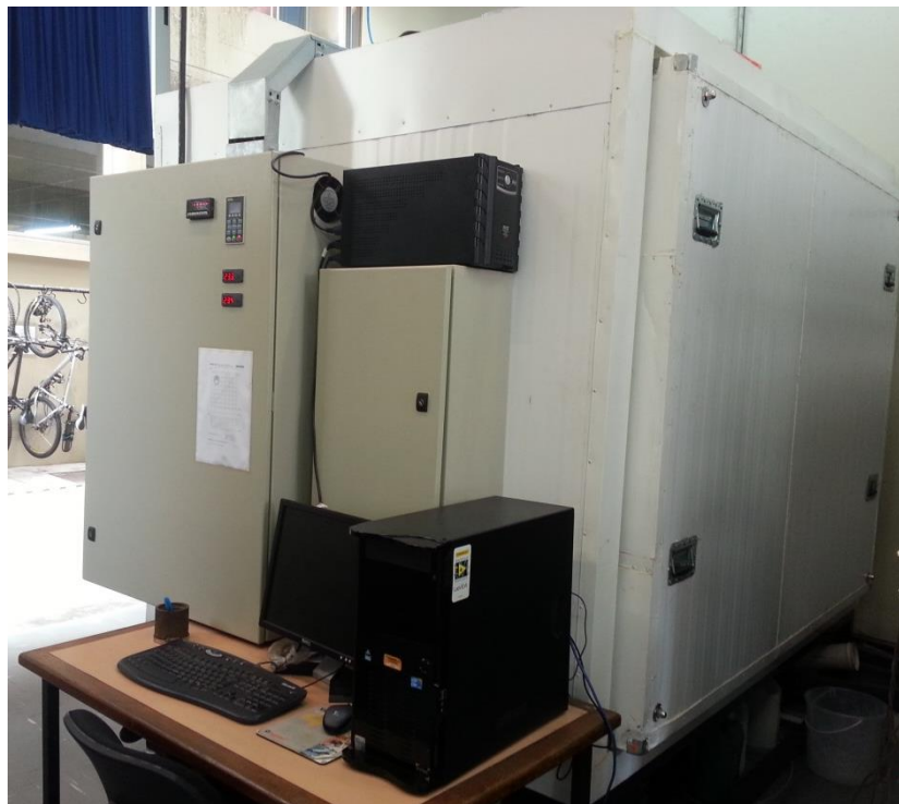
Figura 3.10 – Porta traseira, painéis elétricos e computador
