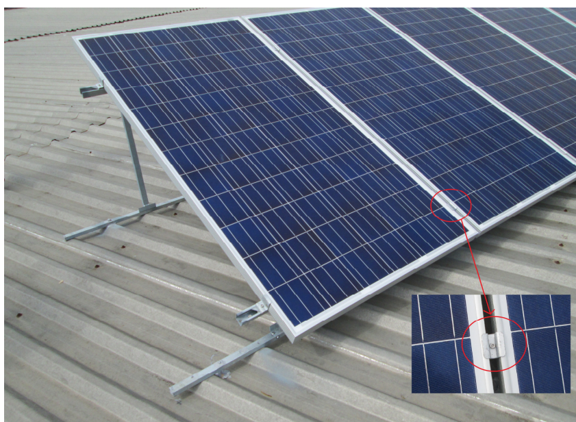
Figura 65 – Estrutura Metálica e Detalhe de Fixação dos Módulos Fonte: Acervo da Autora.
