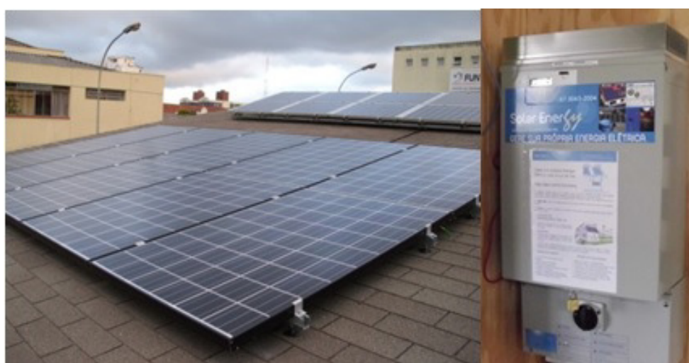
Figura 62 – Vista dos Painéis do EV e do Inversor - Sede Centro Fonte: Urbanetz Junior et al. (2014), Mariano et al. (2016).
