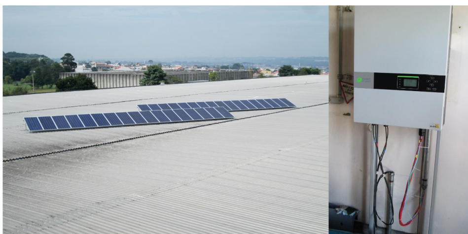
Figura 64 – Vista dos SFVCR e do Inversor da UTFPR - Curitiba Fonte: Urbanetz et al. (2016).
