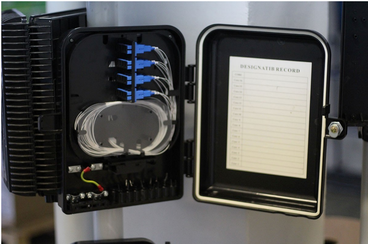
Figura 24 – Caixa de atendimento ótica montada com splitter e acopladores.
