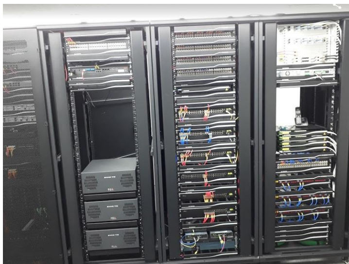
Figura 32. Sala de equipamentos.
