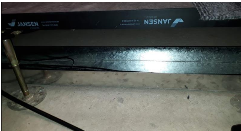
Figura 37. Distribuição do cabeamento horizontal. Fonte: Autor (2018).
