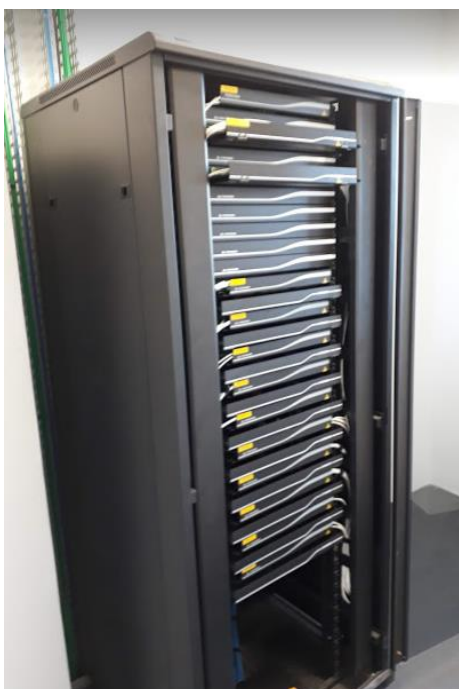
Figura 35. Sala de telecomunicações. Fonte: Autor (2018).
