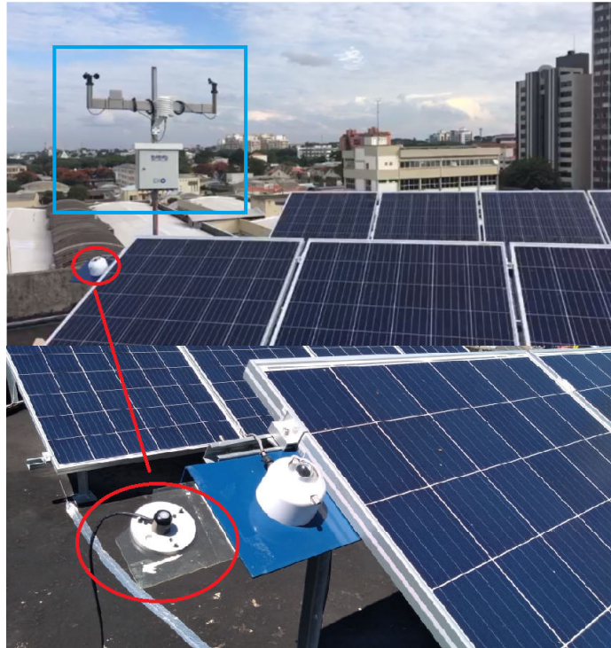
Figura 26 – Sistema de monitoramento das grandezas ambientais.
