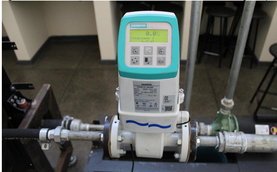
Fotografia 4 - Medidor de vazão volumétrica utilizado no circuito de água aquecida
