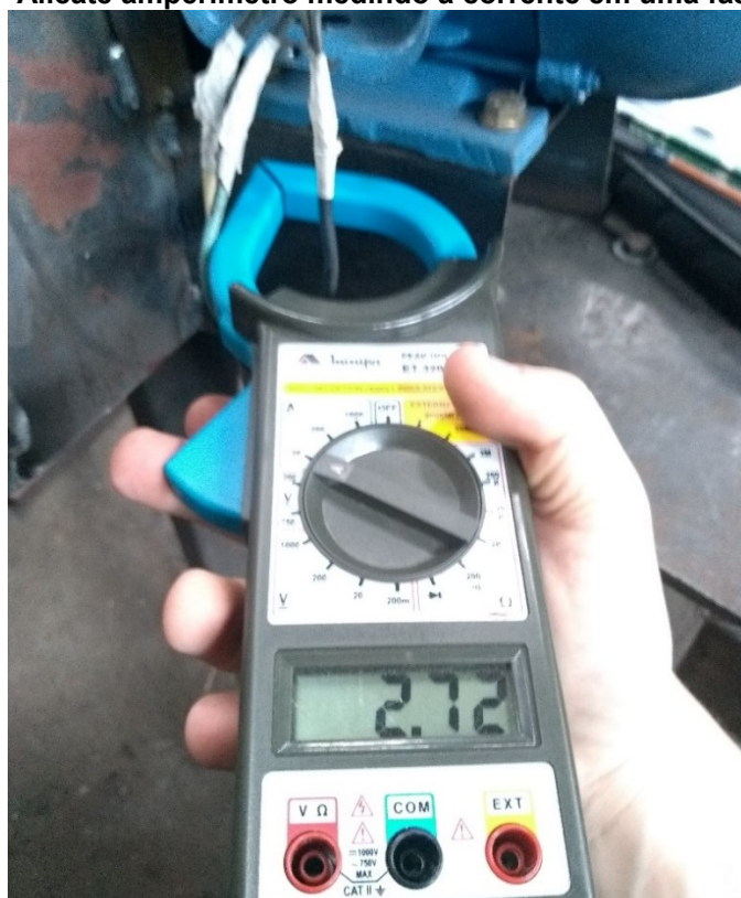
Figura 21 - Alicate amperímetro medindo a corrente em uma fase do motor
