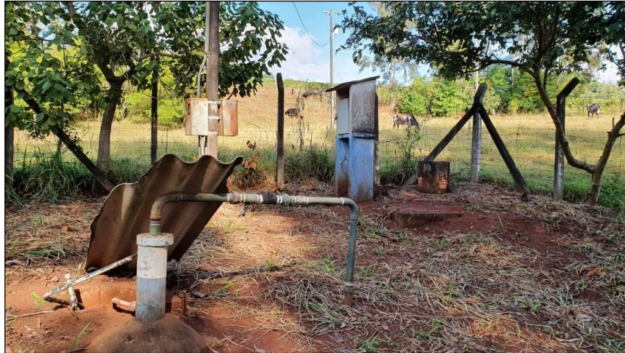
Figura 44 – Poço Artesiano da Comunidade do Km 128
