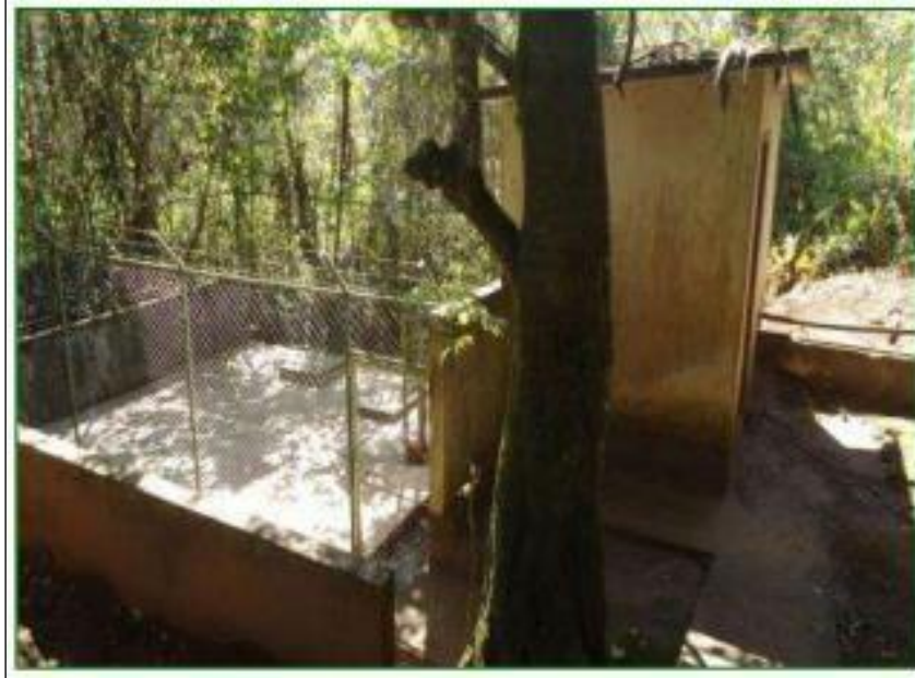
Figura 52 – Reservatório Semi Enterrado e Casa de Bombas Localizado no Distrito de Piquirivaí
