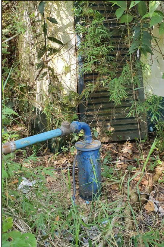
Figura 33 – Estrutura de abastecimento da Comunidade Água da Vespa
