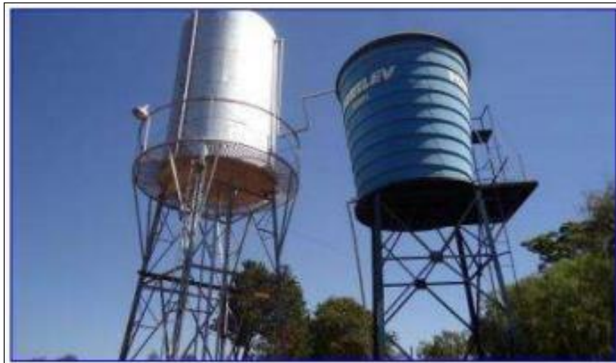
Figura 53 – Reservatórios de Água, localizados no Pátio da Escola em Piquirivaí
