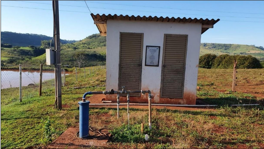
Figura 36 – Estrutura de abastecimento de água da Comunidade Água da Boa Sorte
