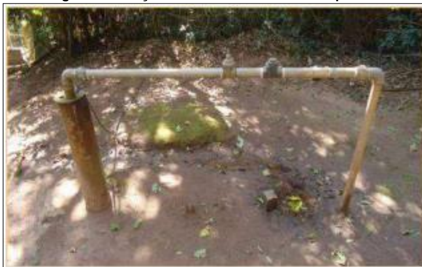
Figura 51 – Poço Artesiano no Distrito de Piquirivai
