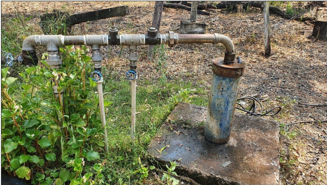
Figura 48 – Poço artesiano da Comunidade Usina Mourão 2
