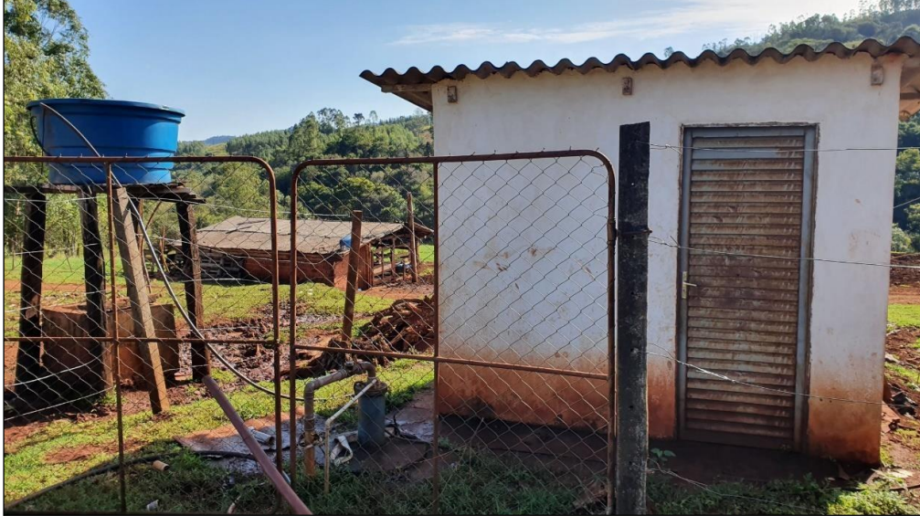
Figura 37 – Estrutura de abastecimento de água da Comunidade Água da Cascata
