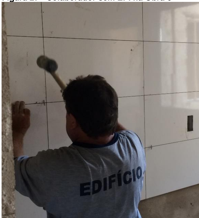
Figura 27 - Colaborador sem EPI na Obra 6
