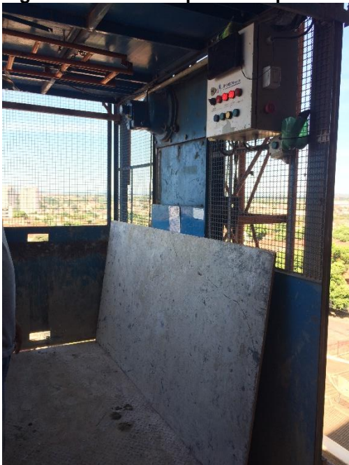
Figura 25 - Elevador para transporte de materiais da Obra 6
