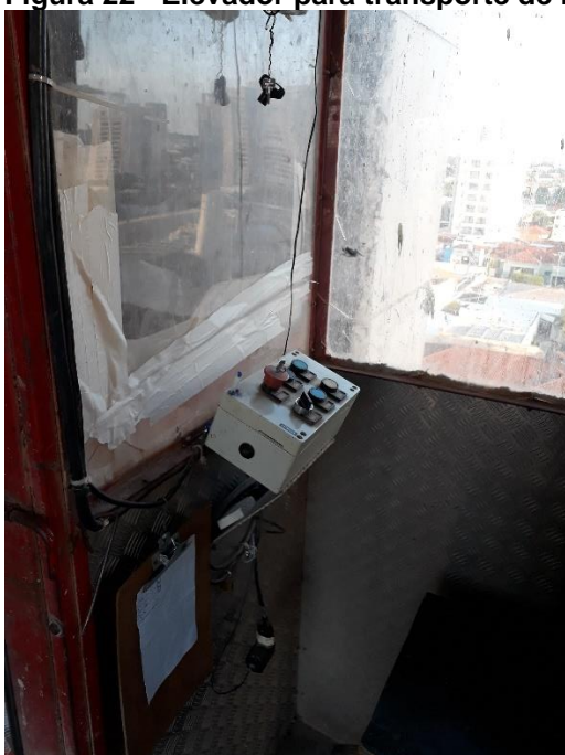
Figura 22 - Elevador para transporte de materiais da Obra 1
