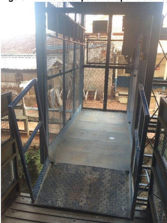
Figura 24 - Elevador para transporte de materiais da Obra 5
