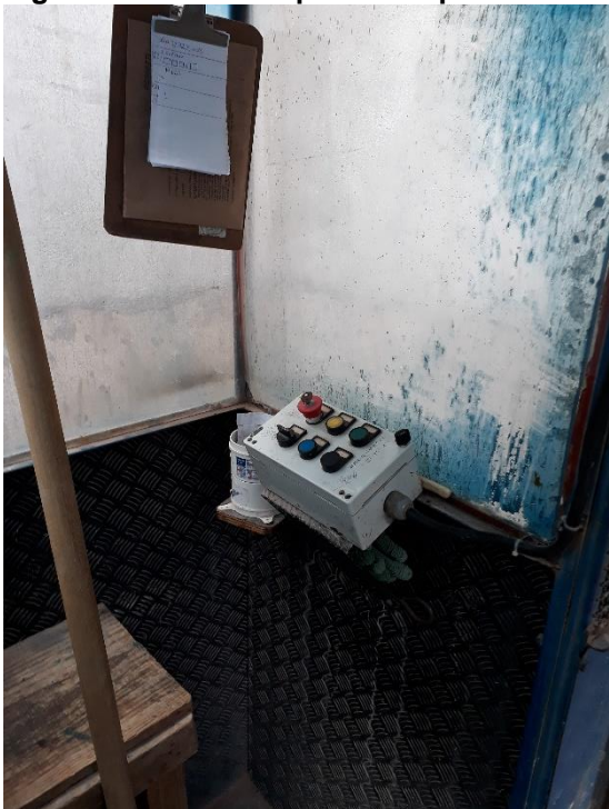
Figura 23 - Elevador para transporte de materiais da Obra 2
