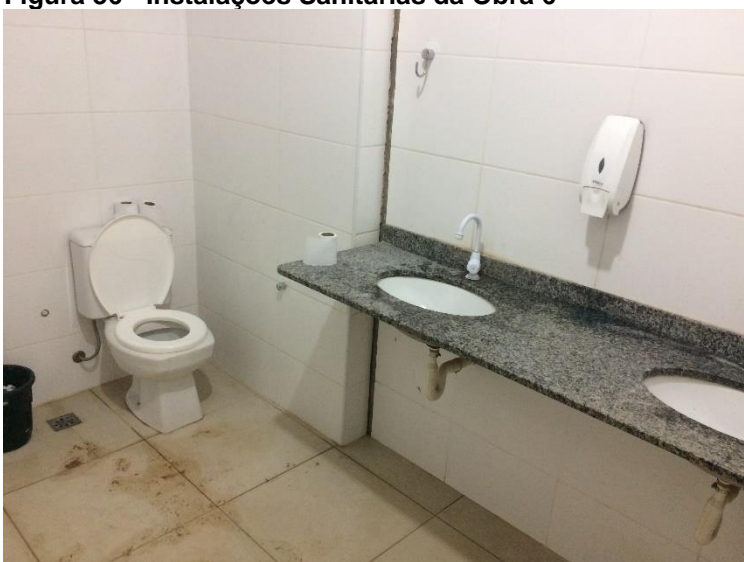
Figura 36 - Instalações Sanitárias da Obra 6
