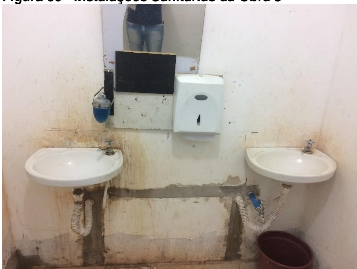
Figura 35 - Instalações Sanitárias da Obra 3
