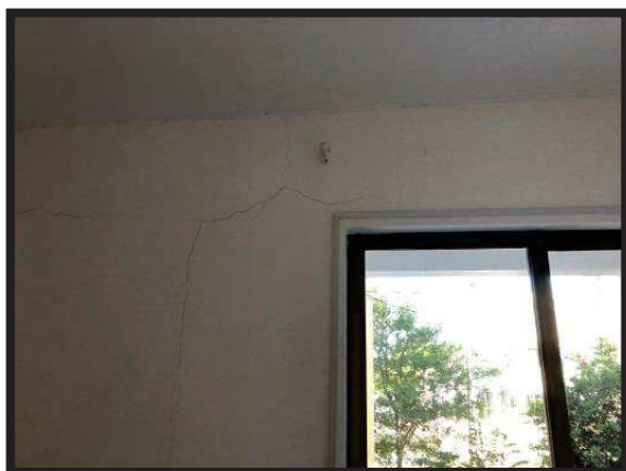
(a) exemplo de fissura a 45°
