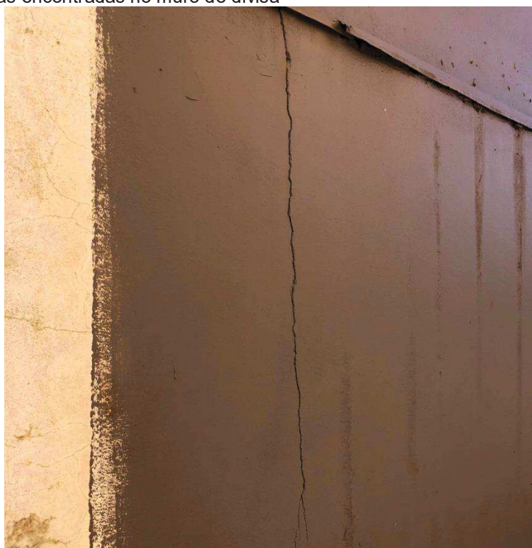
Figura 26 – Fissuras encontradas no muro de divisa
