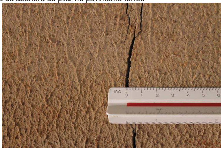
Figura 25 – Análise da abertura do pilar no pavimento térreo
