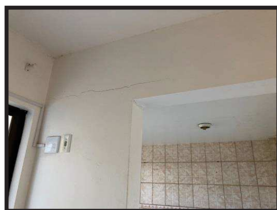
(b) exemplo de fissura horizontal
