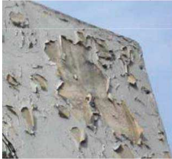
Figura 7 - Descascamento da pintura na parede.
