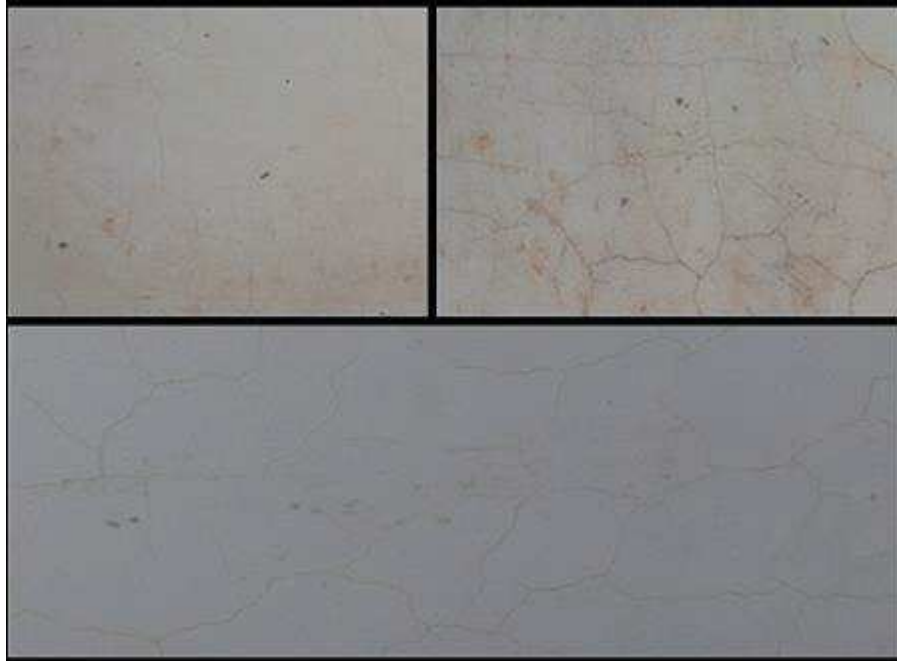
Figura 33 - Fissuras mapeadas presentes nas edificações.
