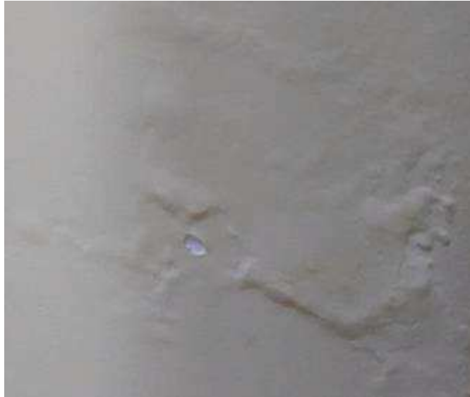
Figura 4 - Surgimentos de bolhas, descolamento da pintura da interface da parede.
