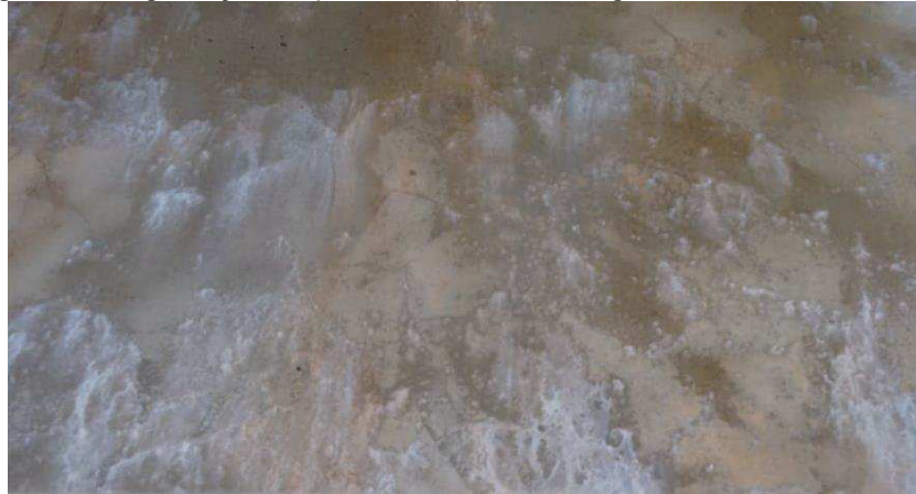
Figura 9 - Degradação de paredes a partir do surgimento de eflorescências.
