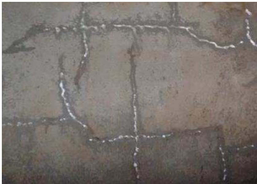
Figura 10 - Surgimento de eflorescências através das fissuras.
