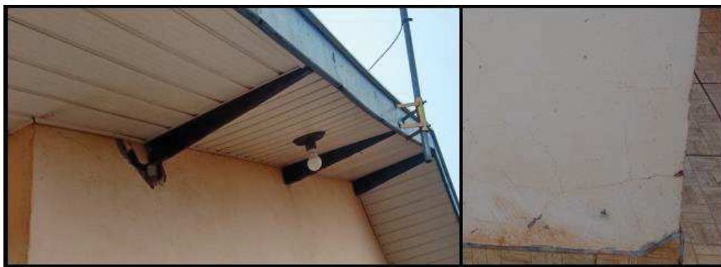
Figura 27– Descolamento de placas representativo das edificações.
