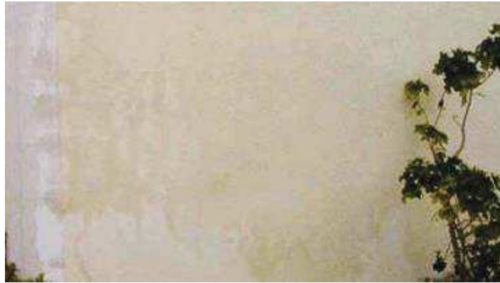
Figura 5 - Manchas de umidade nas paredes.
