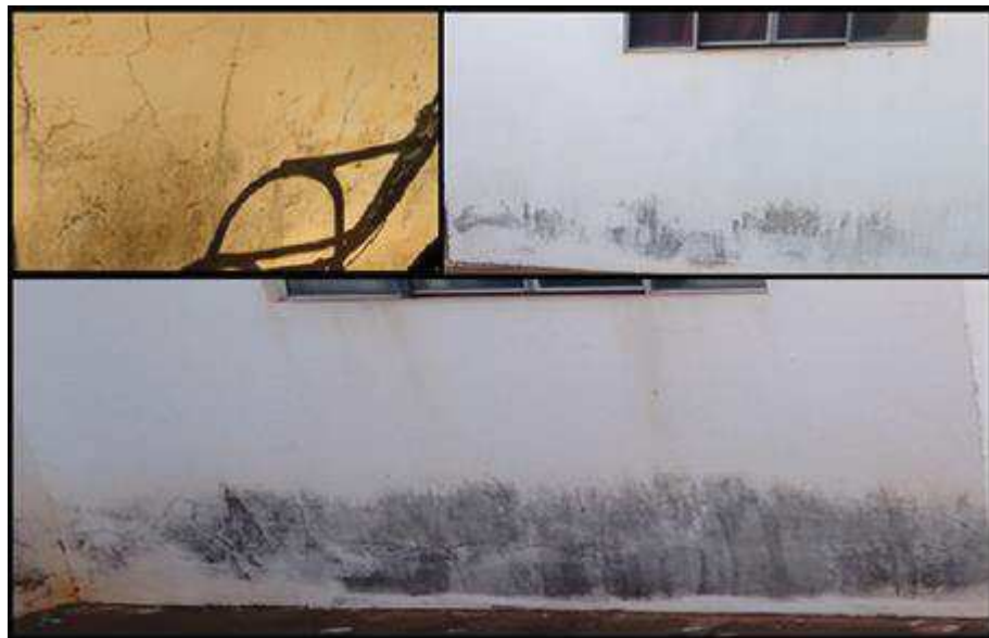
Figura 24 – Edificações com bolor em pontos distintos.
