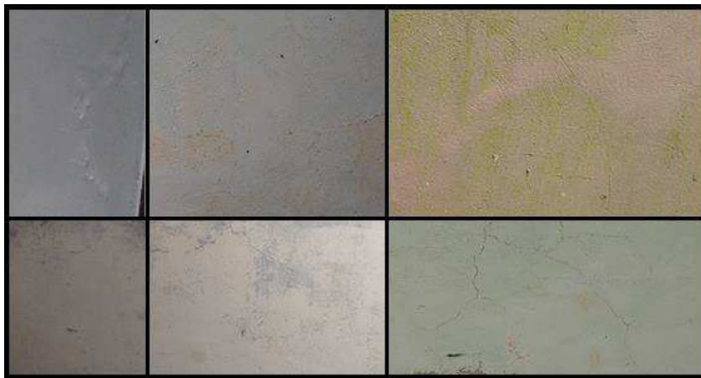
Figura 25 – Edificações com mancha de umidade com diferentes aspectos.
