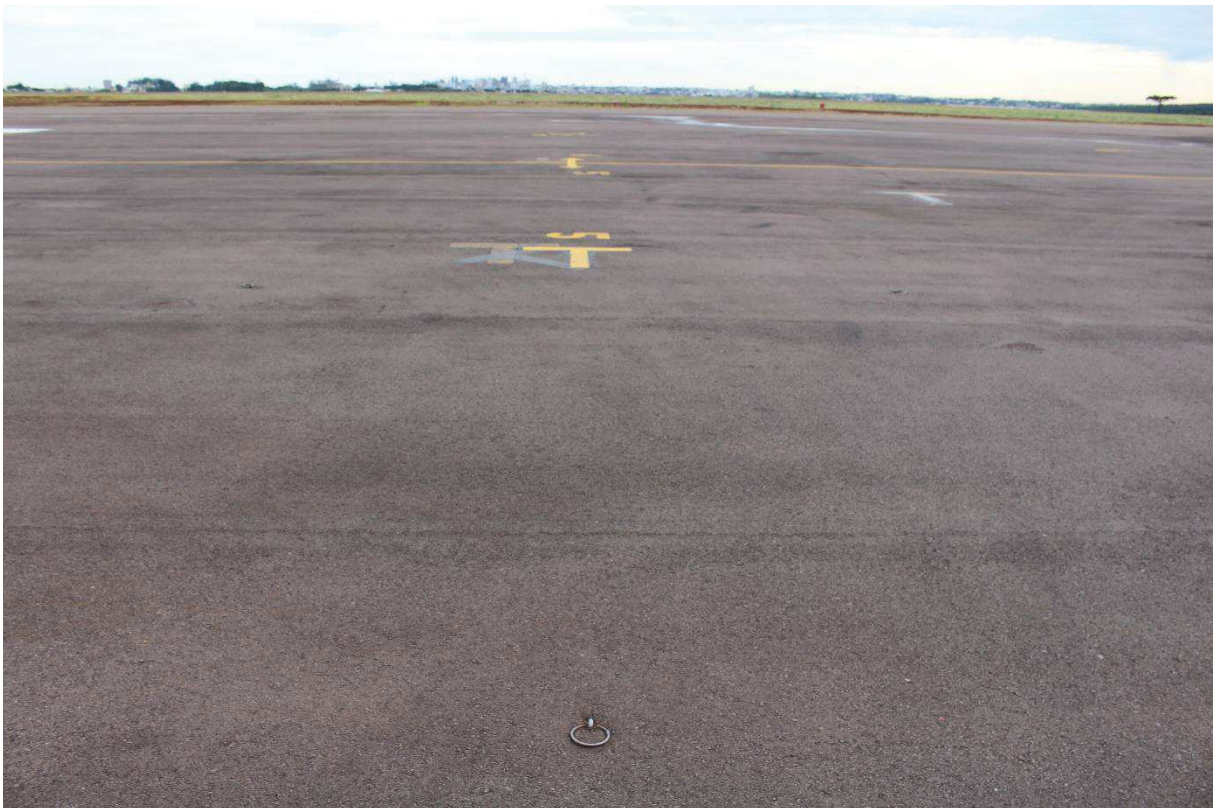
Figura 87- Ganchos fixados no pavimento para fixar aeronaves menores, evitando incidentes com a incidência de ventos.
