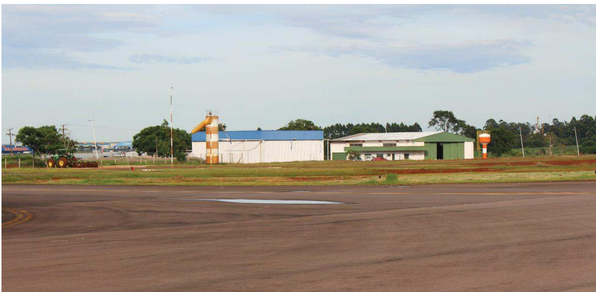
Figura 85- Acúmulo de água na taxiway após 2 dias do registro de precipitação.
