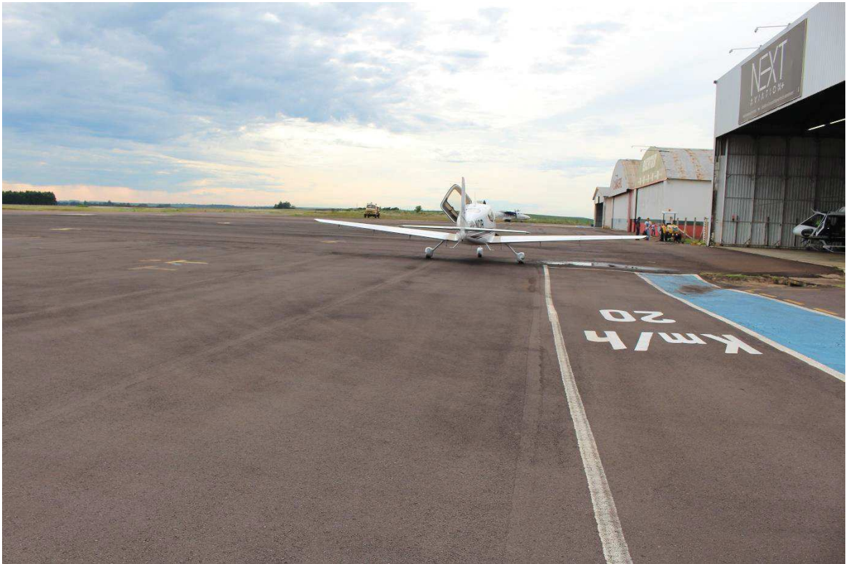
Figura 86- Acumulo de água e depressão no pátio de aeronaves.
