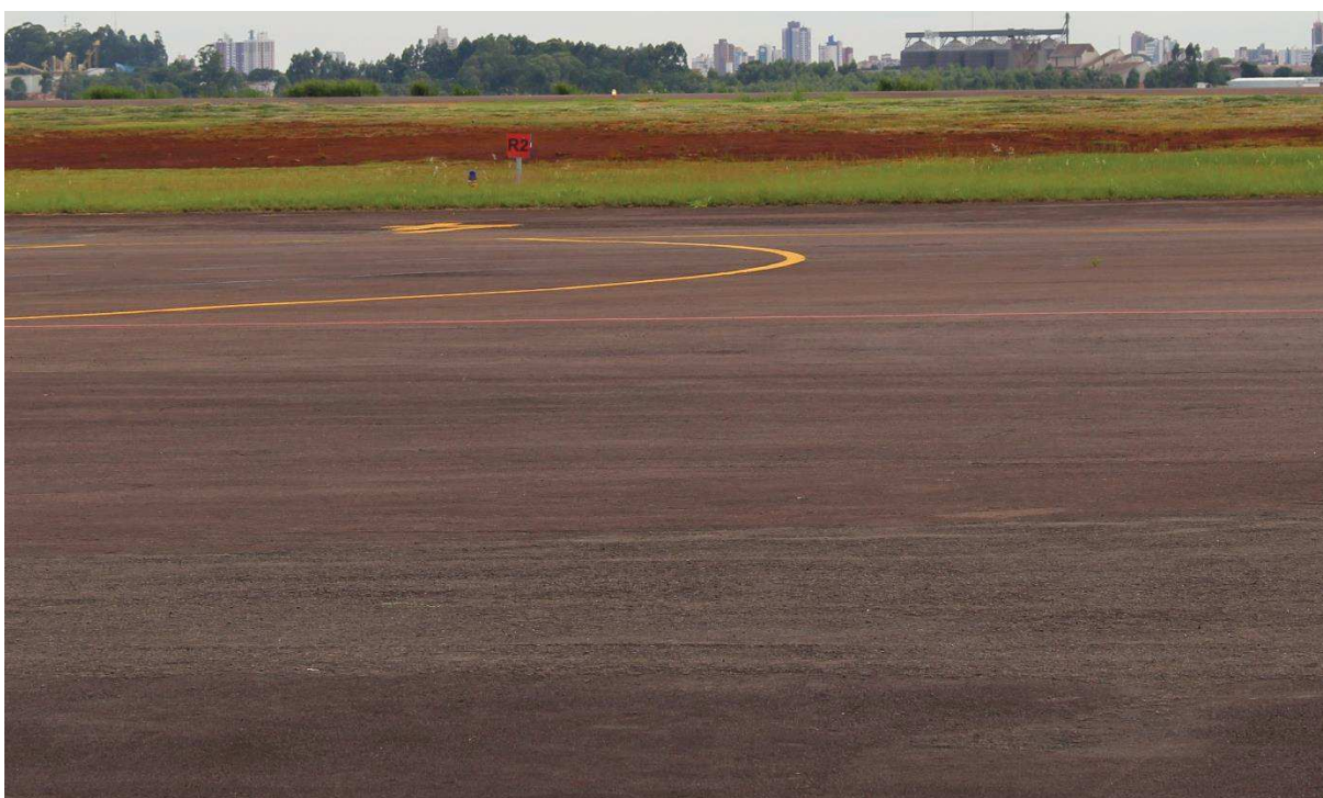
Figura 81- Pavimento do aeroporto com desgastes superficiais
