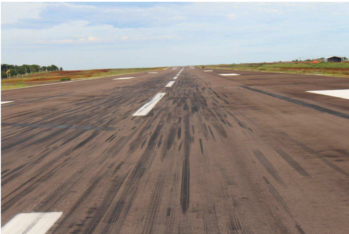
Figura 89- Marcas da Frenagem das aeronaves na pista de Pouso e Decolagem
