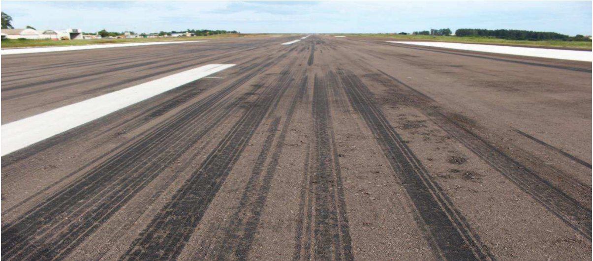
Figura 82- Pavimento do aeroporto com desgastes superficiais
