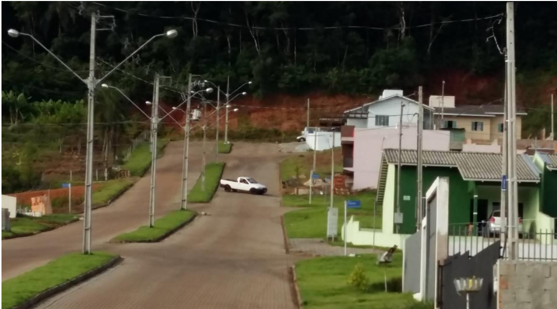
Figura 21 - Foto da área com erosão do solo no Loteamento Marchiori. A erosão se encontra mais acentuada à direita, atrás da residência cor bege.
