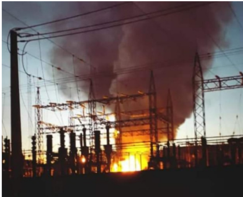
Figura 1 – Explosão em um transformador de subestação da Copel no município de Marechal Cândido Rondon.
