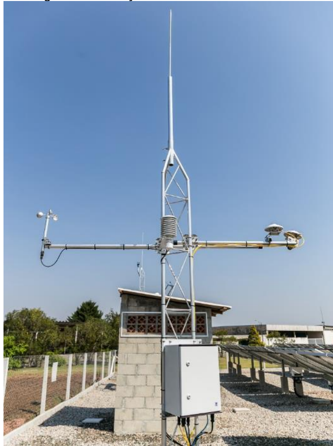
Figura 44 - Estação EPE instalada em Curitiba
