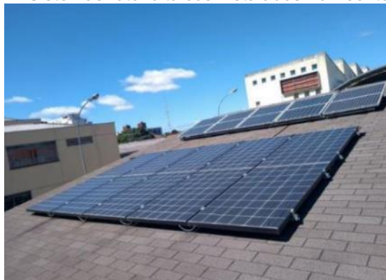
Figura 41 - Sistemas fotovoltaicos instalados no Escritório Verde
