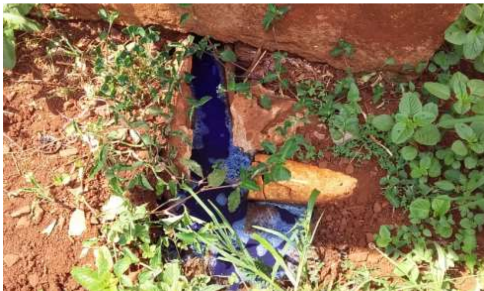
Figura 43. Esgoto de banheiro com corante azul - ligação irregular.
