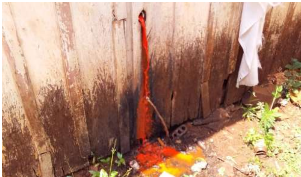
Figura 42. Esgoto da pia com corante vermelho - ligação irregular.
