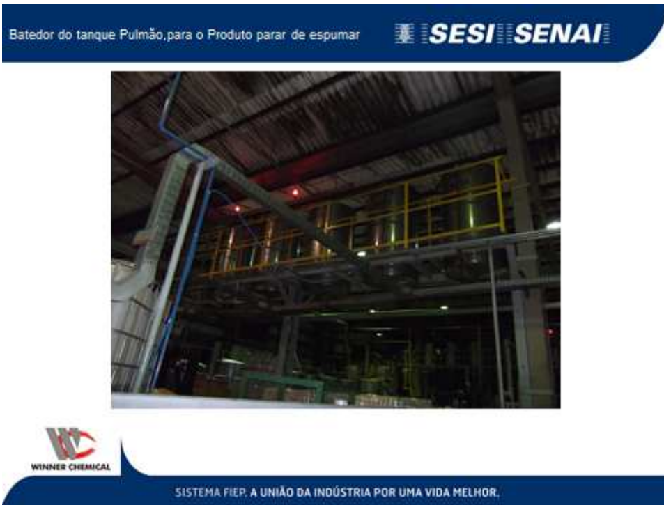
Foto 3: Tanque pulmão / agitador do produto antes do envase
