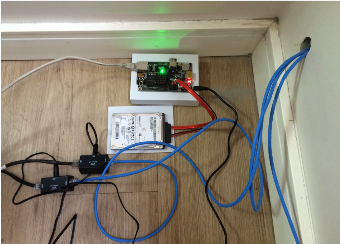
Figura 14 - Localização da Cubieboard e injetores PoE no piso superior Fonte: Autoria própria
