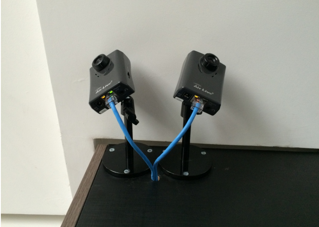
Figura 13 - Detalhe das câmeras com alimentação PoE Fonte: Autoria própria
