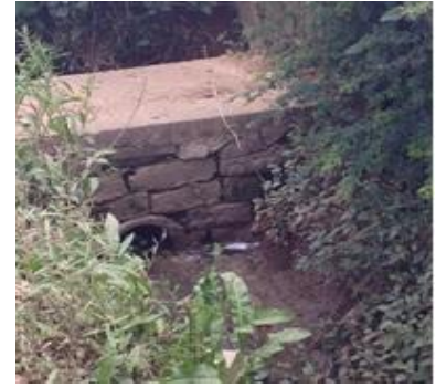
Foto 6 Esgoto a céu aberto em frente a ETE São João. Autoria: Nunes, Claudia T (2013)
