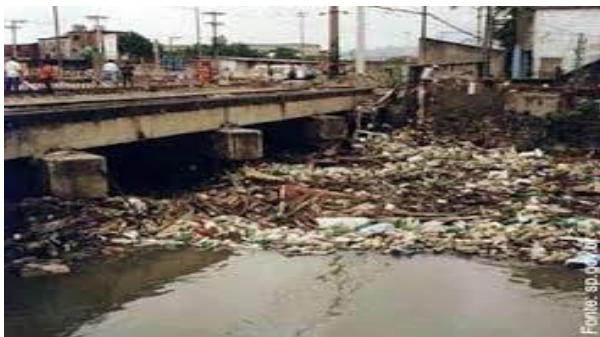
Figura 1 – obstrução da ponte devido ao acúmulo de lixo. Fonte: WWW.mundoeducacao.coM
