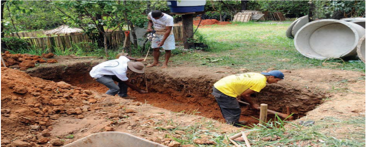
Figura 07: Vala dos Tanques Sépticos. Fonte: Aleudo (2010).
