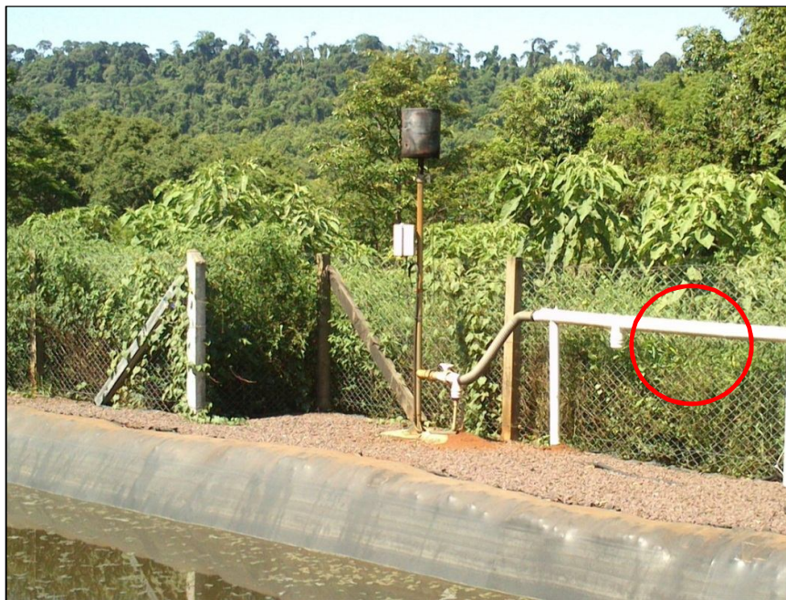
Figura 7. Flare utilizado para queima de biogás e possível local de instalação de um medidor
