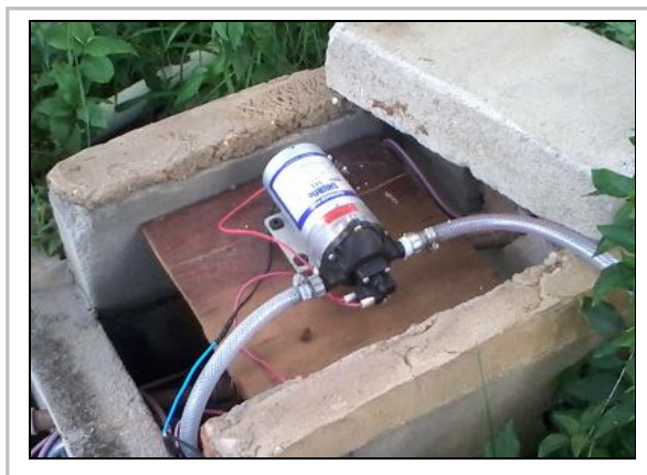
Figura 8. Bomba movida à placa solar. Fonte: Autor
