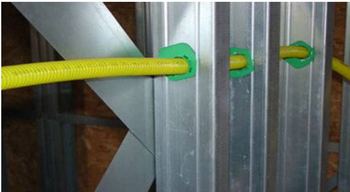
Figura 06: Tubulação Elétrica Fonte: O Autor (2015).
