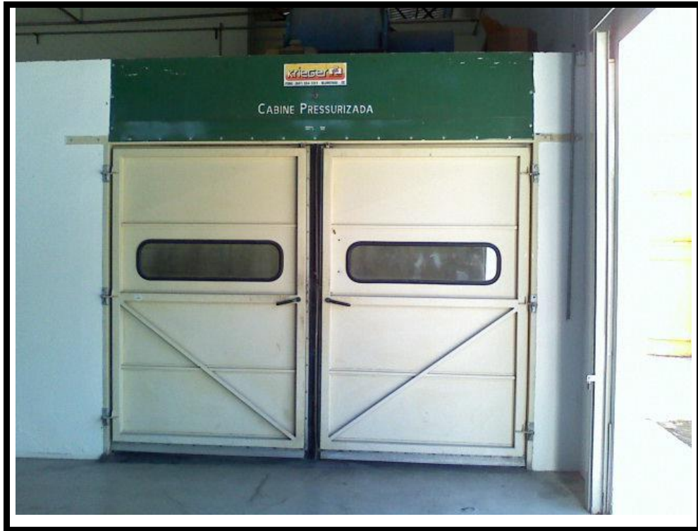
Figura 11 - Cabine de Pintura da Concessionaria. Parte Externa. Fonte: A Autora (2015)
