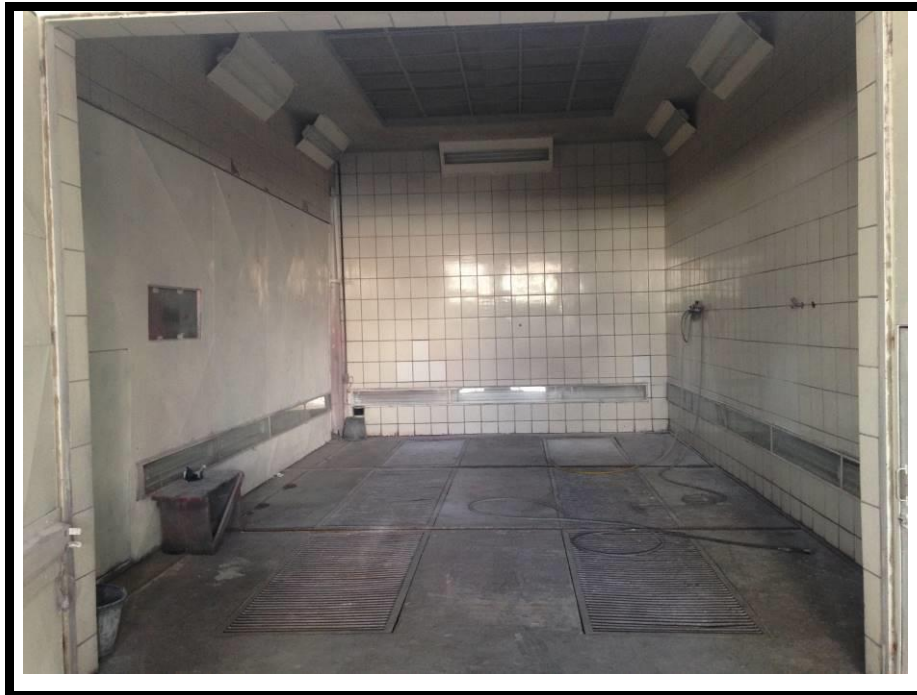
Figura 10- Cabine de Pintura da Concessionaria. Parte Interna. Fonte: A Autora (2015)
