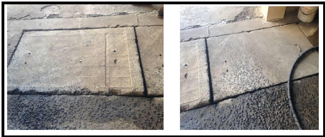
Figura 16 - Local onde se Encontra as Caixas Separadoras de Água e Óleo. Fonte: A Autora (2015).
