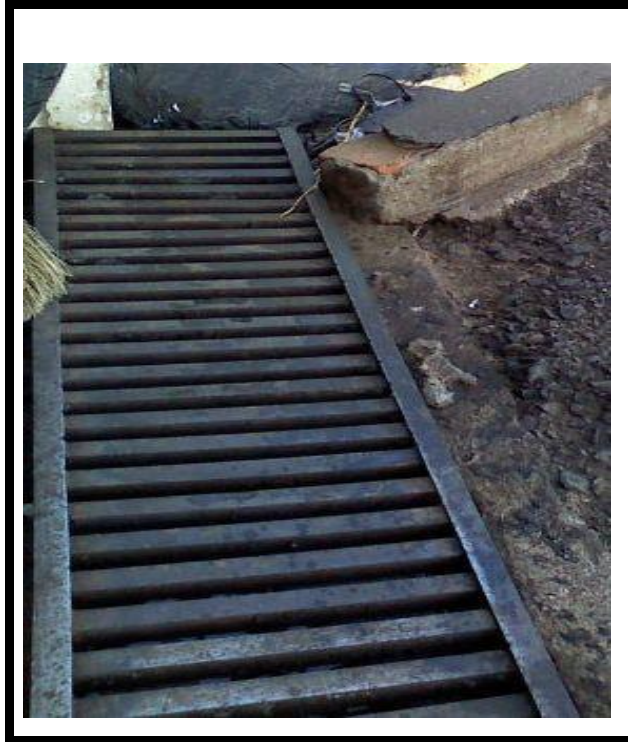
Figura 15 - Canaleta para Escoamento de Efluentes da Lavagem dos Carros. Fonte: A Autora (2015).
