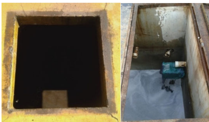
Figura 3. Caixa SAO e reservatório de armazenamento do efluente da lavanderia
