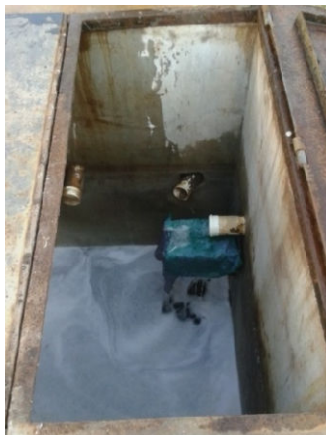
Figura 3. Reservatório de armazenamento do efluente da lavanderia
