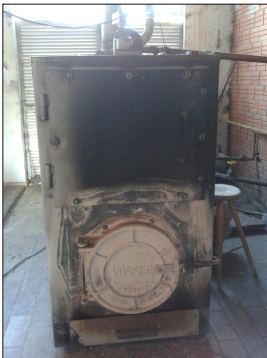
Figura 14. Caldeira de queima dos Pellets Falls Galli Hotel.
