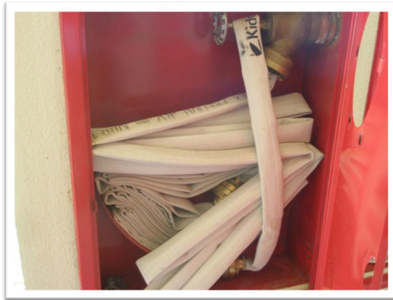
Figura 19– Hidrante parte interna Fonte: MEIRA, Francieli Aparecida. Arquivo pessoal (2014).
