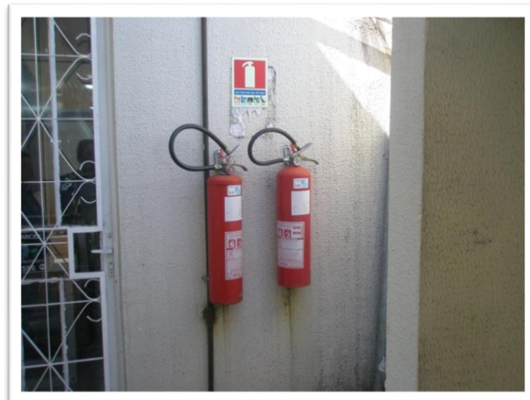
Figura 14 – Extintores na central de gás Fonte: MEIRA, Francieli Aparecida. Arquivo pessoal (2014).
