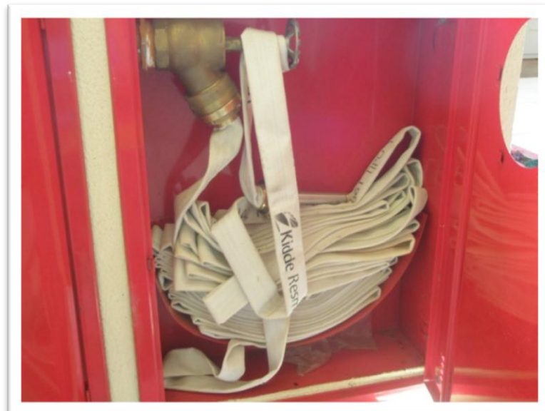
Figura 18 – Hidrante parte interna Fonte: MEIRA, Francieli Aparecida. Arquivo pessoal (2014).
