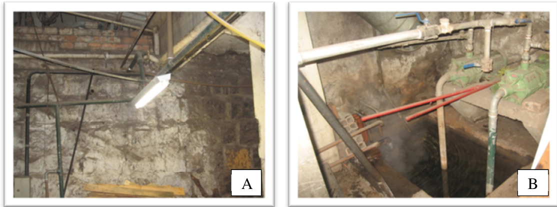
Figura 6 - Iluminação noturna inadequada (A) e Reservatório de água aquecida (aberto) (B)
