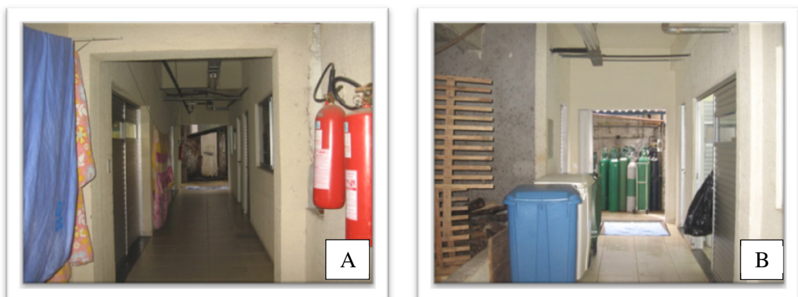
Figura 5 - Saídas de emergências da caldeira 2: Saída n.º1 , onde observa-se a instalação dos extintores (A) e Saída n.º2 , Corredor com obstruções, com os contêineres para resíduos no local (B) Fonte: BEUX, Giovana. Arquivo pessoal (2013)
