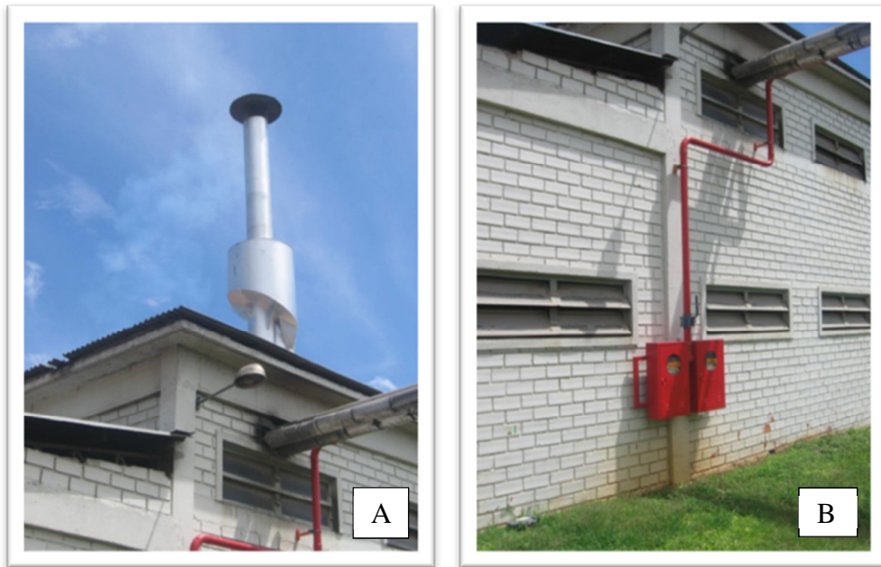
Figura 3 - Chaminé da caldeira 1, (A) Sistema hidráulico preventivo por hidrante, (B) Fonte: BEUX, Giovana. Arquivo pessoal, 2013
