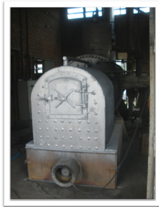
Figura 1 - Vista frontal da caldeira 1
