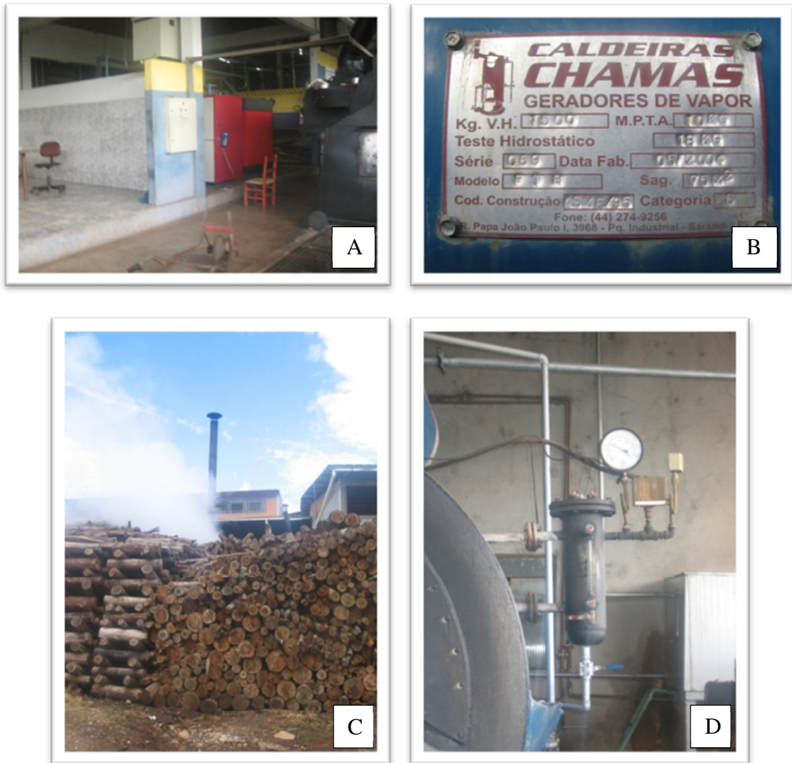
Figura 13 - Refeitório ao lado da caldeira 4 (A) e Placa de identificação (B) Saída obstruída com disposição de material lenhoso (C), e Manômetro e Sensor de nível (D)
