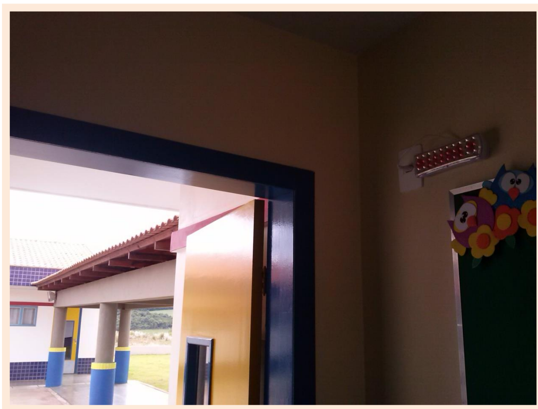
Foto 10 – Iluminação de emergência Creche N°02 FONTE: Dados da pesquisa (2015) FOTOS de Marcio Gamba
