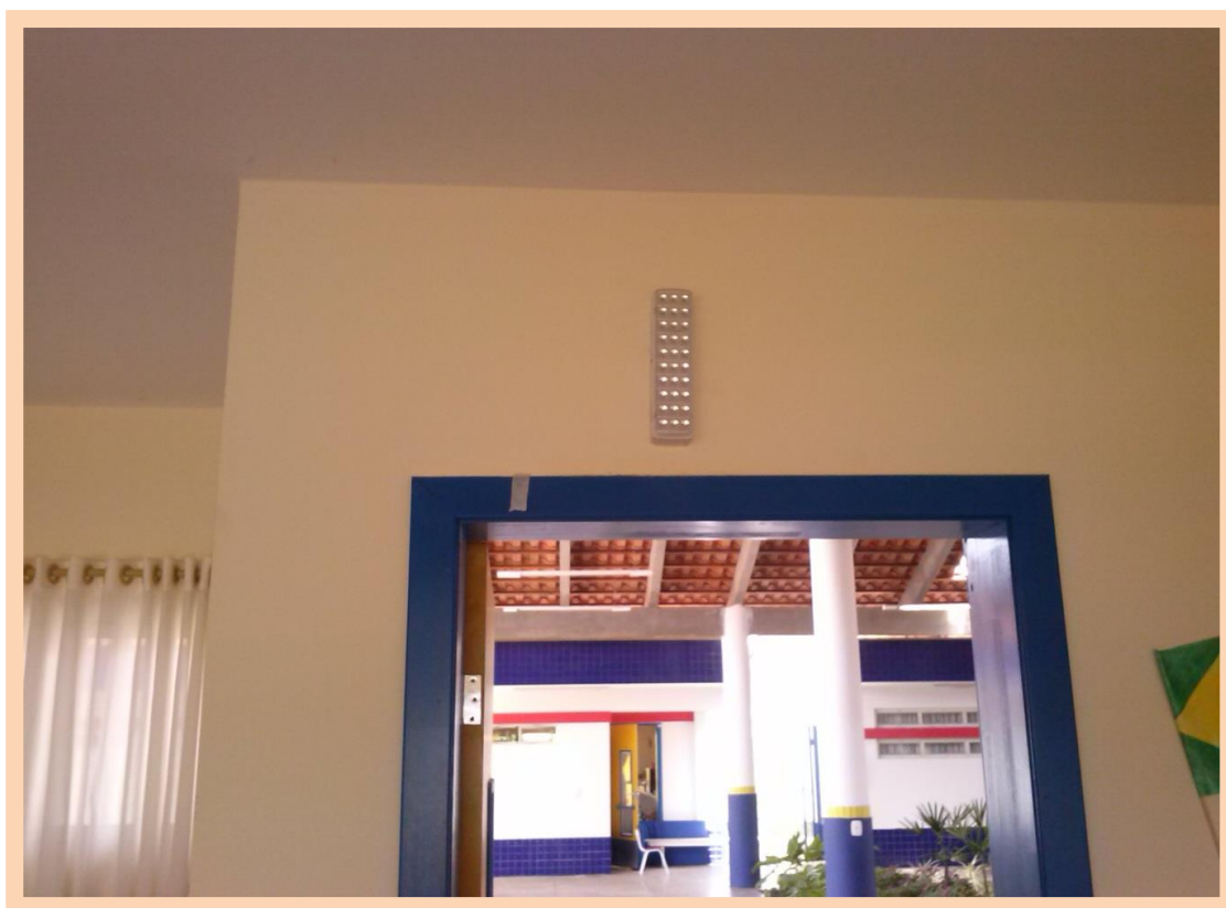
Foto 12 – Iluminação de emergência instalada incorretamente FONTE: Dados da pesquisa (2015) FOTOS de Marcio Gamba
