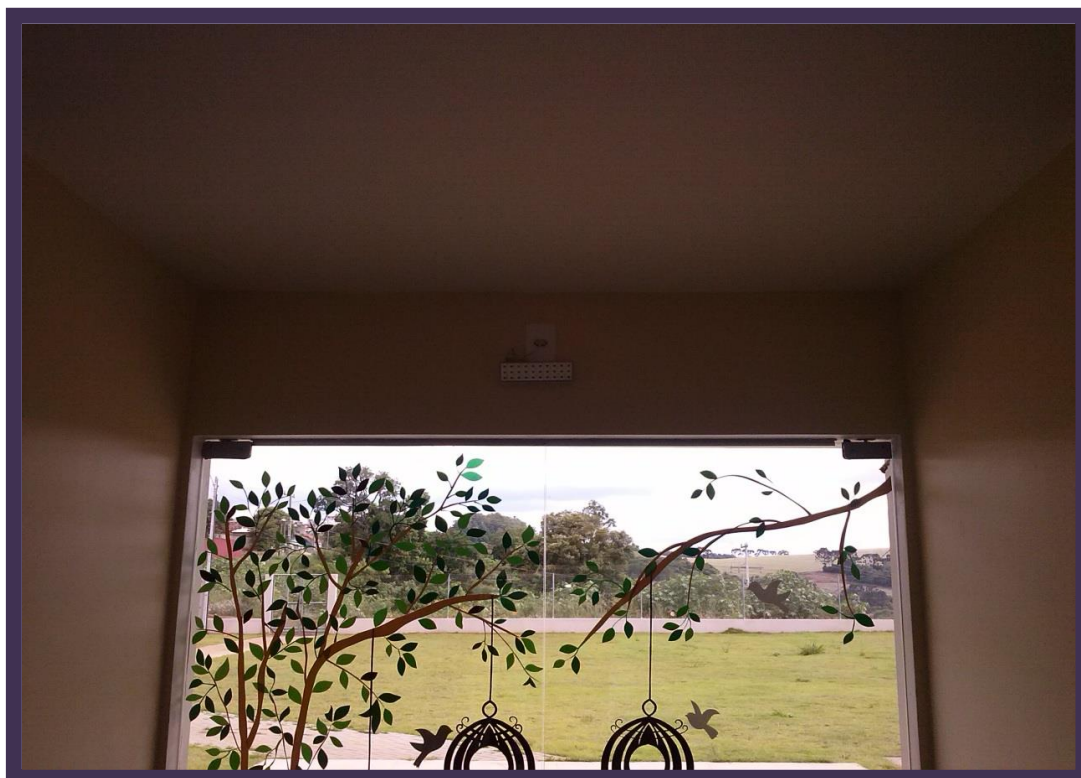
Foto 15 – Iluminação de emergência FONTE: Dados da pesquisa (2015) FOTOS de Marcio Gamba
