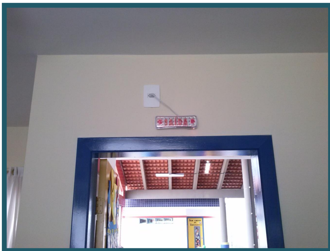
Foto 08 – Iluminação de emergência Creche N°02 FONTE: Dados da pesquisa (2015) FOTOS de Marcio Gamba
