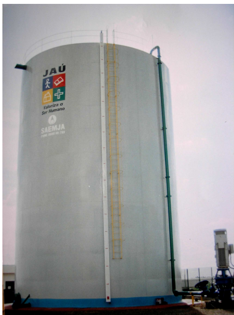
Fig (4) – Reservatórios do Bairro Nova Jaú Fonte: Arquivo Saemja. nov. 2010.
