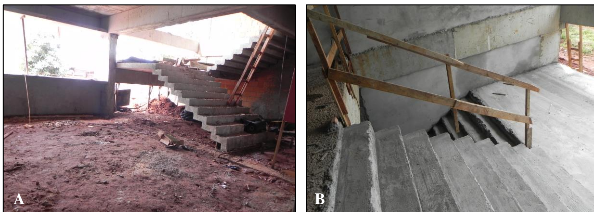
Figura 52 - Escada interna da obra. A) Escada sem corrimão e sem guarda corpo, e ainda contendo uma escada individual apoiada para acesso ao primeiro pavimento; B) Correção da utilização da escada interna da obra: confecção do corrimão e guarda corpo.
