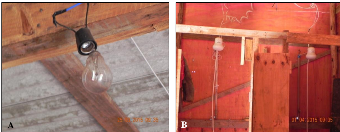
Figura 15 - Não conformidades encontradas nas instalações elétricas da área de vivência. A) Instalações elétricas improvisadas, em desacordo com a norma; B) Chuveiro sem aterramento, com instalação elétrica inadequada; sem caimento adequado do piso; e sem suporte para sabonete. Fonte: a autora (2016).
