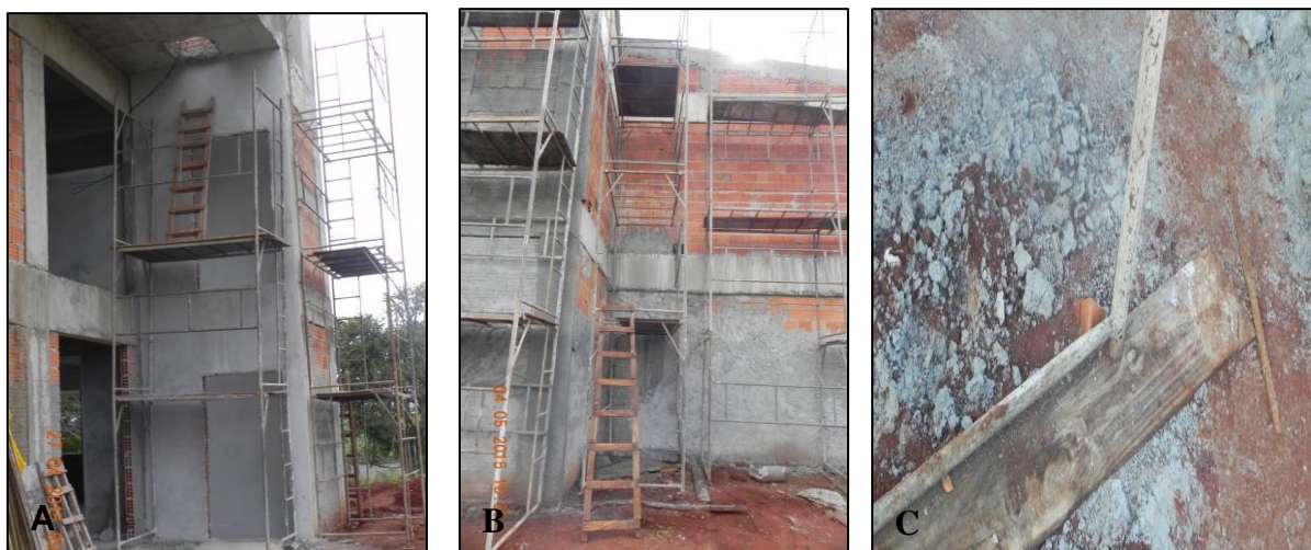
Figura 65 - Utilização de andaimes no canteiro de obras. A) Utilização de escada sobre o piso do andaime; B) Acesso inseguro ao andaime; C) Fixação não segura do andaime no solo. Fonte: a autora (2016)
