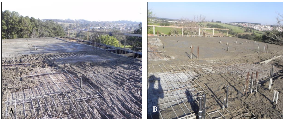
Figura 46 - Concretagem da laje interrompida em virtude da baixa resistência de fôrmas e escoras. A) Vista da laje, com o concreto sem vibração adequada; B) Vista da laje, com o concreto sem nivelamento adequado. Fonte: a autora (2016)
