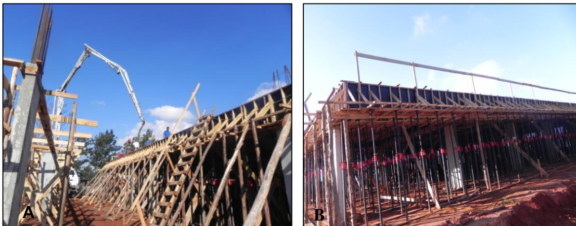
Figura 58 - Concretagem da laje do primeiro pavimento. A) Falta de proteção contra queda de trabalhadores; B) Guarda corpo com características incompatíveis com a NR 18. Fonte: a autora (2016)
