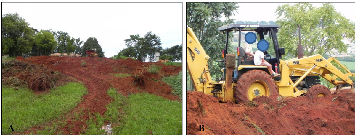
Figura 22 - Não conformidades encontradas nas escavações. A) Raízes de árvores existentes na execução da fundação; B) Acesso de pessoas não autorizadas.
