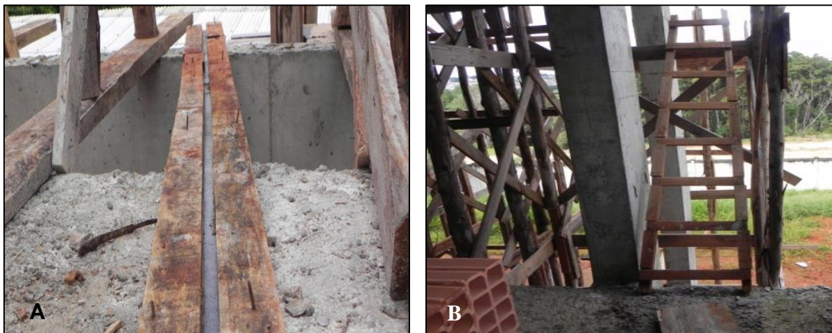
Figura 53 - Não conformidades encontradas. A) Passarela improvisada sem nenhuma segurança; B) Escada apoiada na proximidade de abertura.
