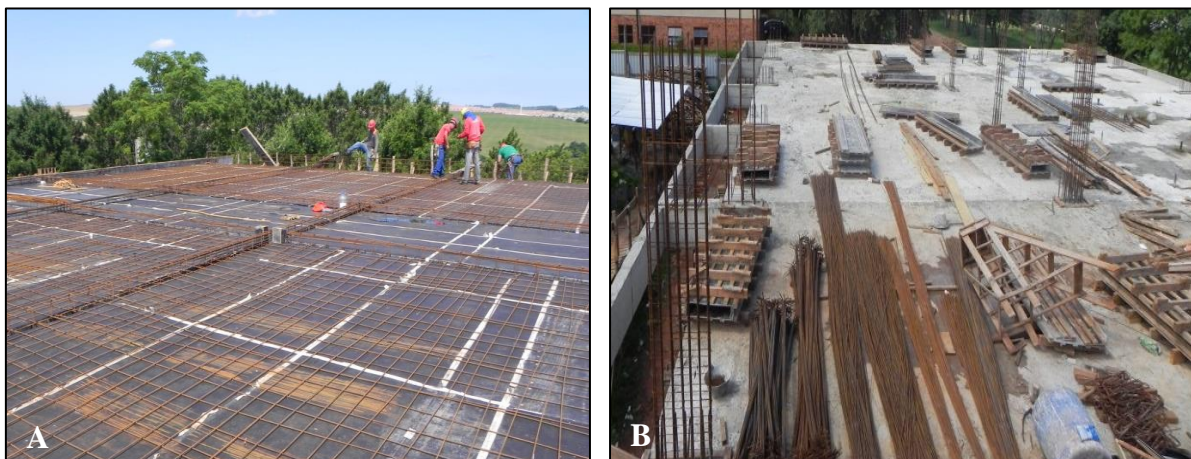
Figura 39 - Não conformidades encontradas na montagem da ferragem in loco . A) Falta de colocação de pranchas de madeira firmemente apoiadas sobre as armações na fôrma da laje para circulação; B) Vergalhões desorganizados, com pontas desprotegidas; Armações dos pilares sem escoras, sujeitos a tombamento. Fonte: a autora (2016)
