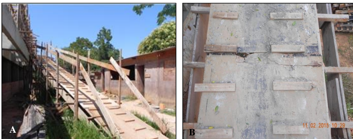
Figura 51 - Não conformidades encontradas na utilização da rampa de acesso. A) Falta de rodapé na rampa; B) Rampa feita com materiais de qualidade insuficiente, sem dimensionamento correto e falta de manutenção. Fonte: a autora (2016)
