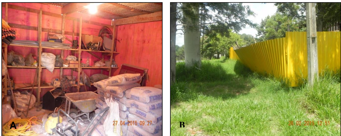
Figura 83 - Condições não seguras no local de armazenamento de materiais e tapumes. A) Local desorganizado, com materiais espalhados; B) Tapume executado sem resistência adequada. Fonte: a autora (2016)
