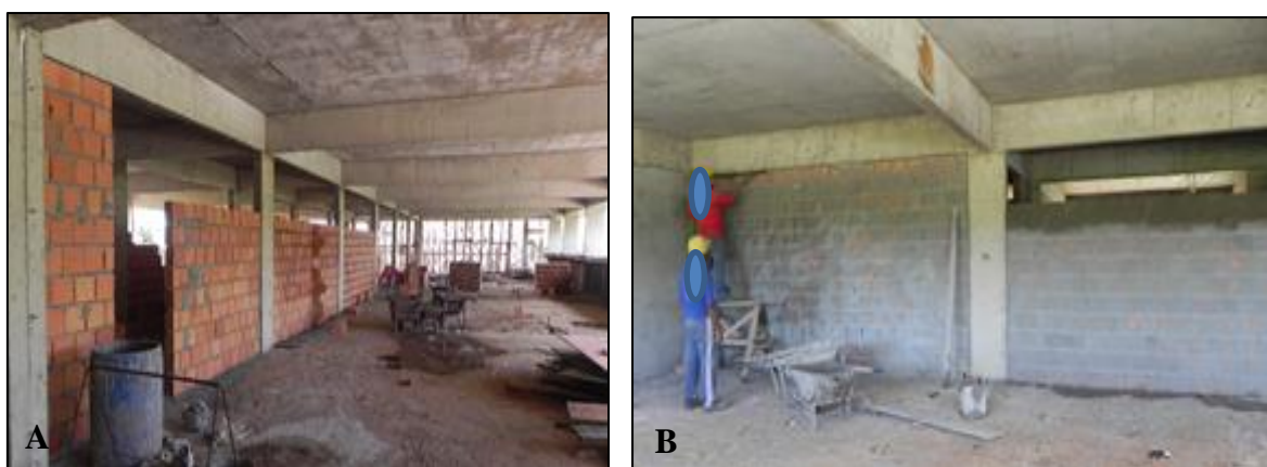
Figura 71 - Condições não seguras na execução de alvenarias e revestimentos. A) Periferia da laje sem proteção contra queda de altura; B) Utilização de estrutura inadequada para execução do encunhamento da alvenaria.
