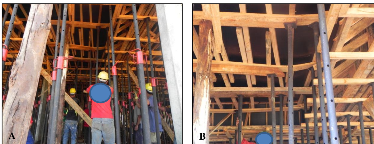
Figura 44 - Incidente na concretagem da laje. A) Funcionários verificando o problema das fôrmas e escoras; B) Resistência de fôrmas e escoras inferior à carga da edificação. Fonte: a autora (2016)
