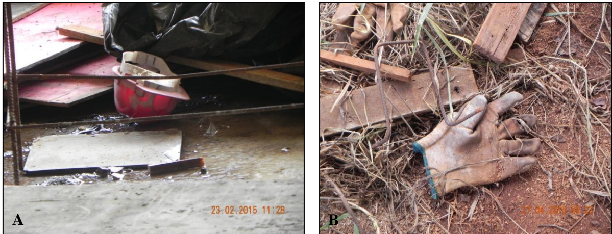
Figura 82 - Não conformidades com relação aos EPIs. A) Capacete de segurança no chão, com resíduos de construção civil; B) Luva de segurança no chão, sem cuidado de conservação e higiene. Fonte: a autora (2016)
