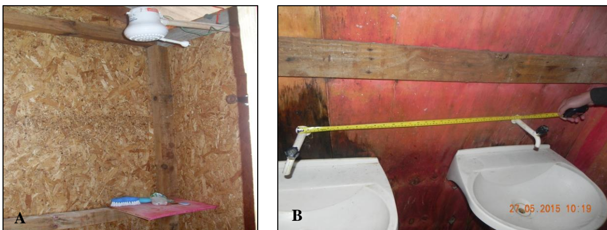
Figura 16 - Correção de Não Conformidades. A) Correção do ambiente destinado aos chuveiros, com aterramento adequado; B) Correção dos espaçamentos entre as torneiras dos lavatórios. Fonte: a autora (2016).
