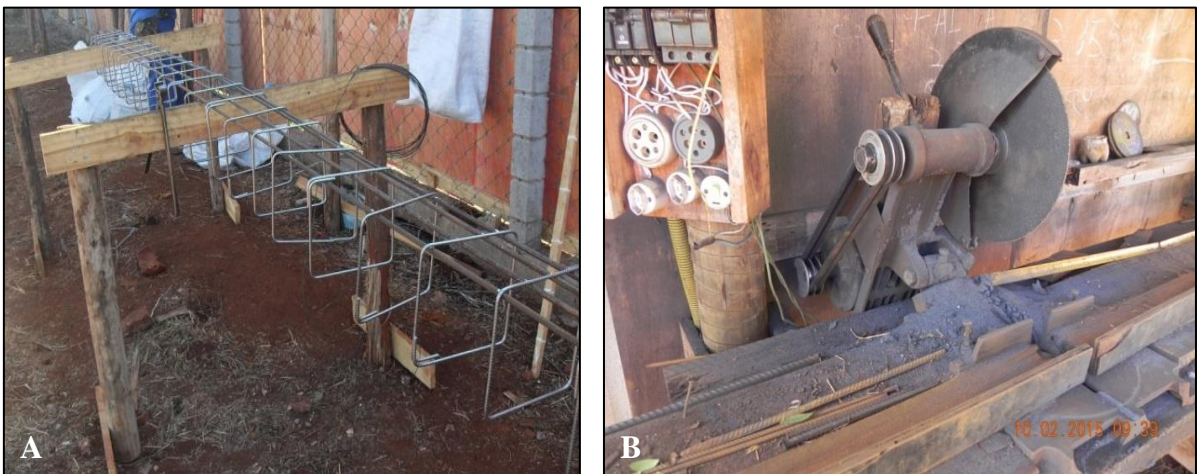
Figura 38 - Área de corte e montagem das armações da estrutura. A) Melhoria na área da bancada de trabalho: suporte para montagem de dobras e amarrações, ergonomicamente correta; B) Máquina de corte da ferragem sem manutenção e limpeza; instalações elétricas inadequadas. Fonte: a autora (2016)
