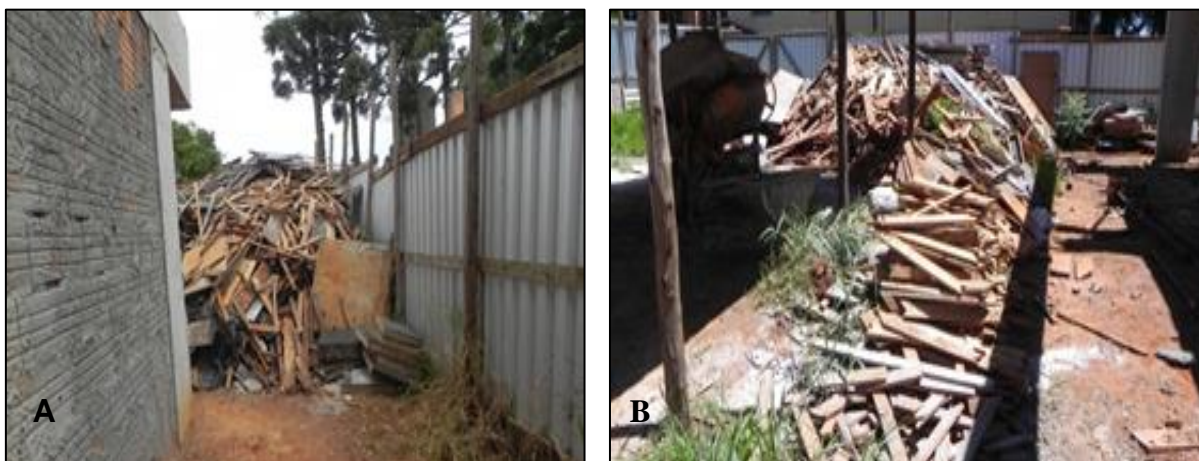
Figura 84 - Não conformidades com relação à ordem e limpeza do canteiro de obras. A) Resíduos de construção civil; B) Resíduos de construção civil na circulação e próximo a equipamentos.
