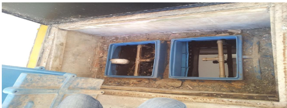
Figura 10: Caixa de inspeção
