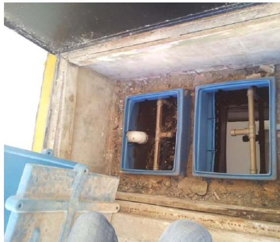
Figura 7: Águas resultantes da lavagem da cabine de pintura.
