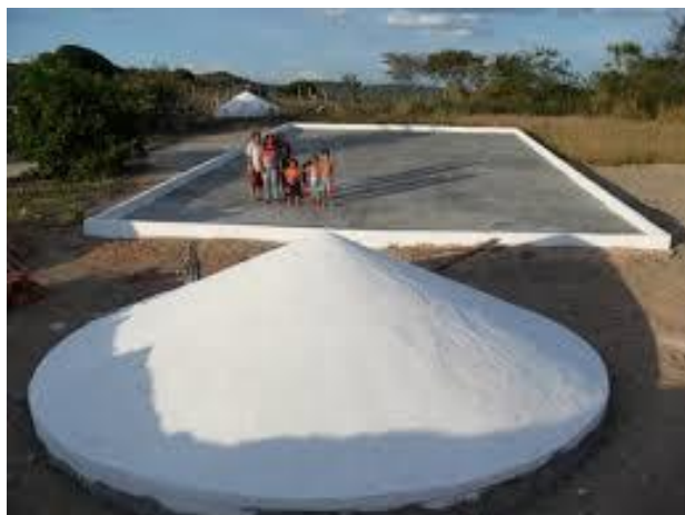
Figura 8. Cisterna tipo calçadão em Lagoa Grande-BA.
