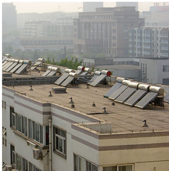
Figura 16 – Painéis de aquecimento solar em Rizhao - China Fonte: http://newx.soloclima.com/noticias/energia-solar/el-paraiso-de-la-energia-solar-termica-se-llama-rizhao-y-esta-en-china (Acesso em: 04 nov 2011)
