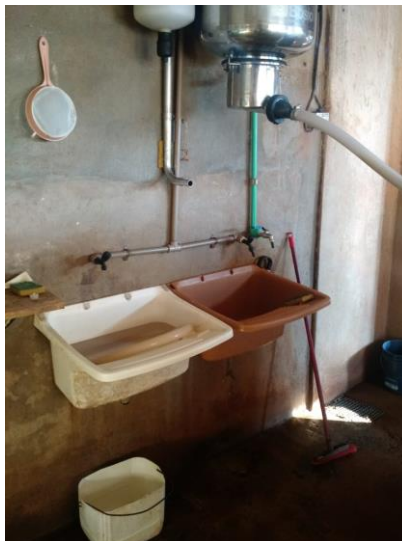
Figura 12 - Local de lavagem dos utensílios com sistema automático de aquecimento.
