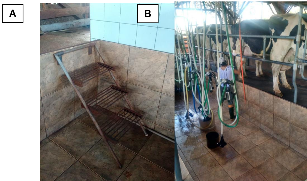
Figura 19 - Riscos de acidentes. a) Ausência de corrimão na escada de acesso ao fosso. b) Acúmulo de água no fosso.
