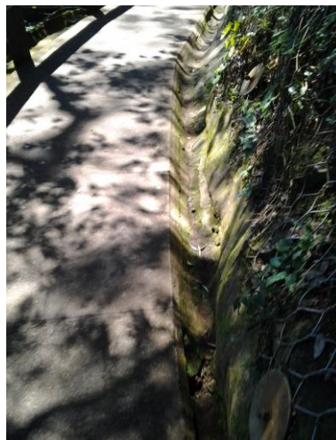
Figura 10: Falta de rodapé e corrimão Fonte: Autor
