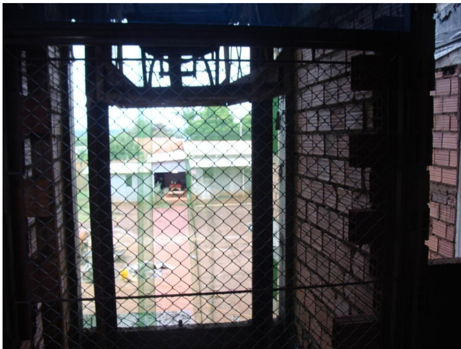
Figura 31 - Proteção em Vão do Elevador Fonte: Edilene Cristina Gribeler, 2012
