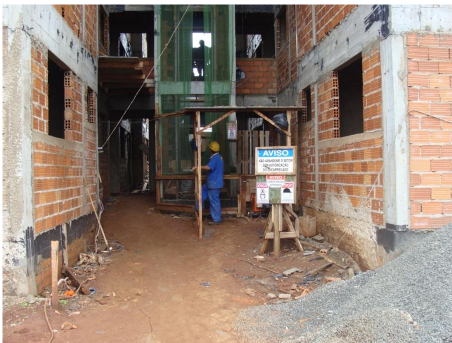
Figura 30 - Sinalização e Proteção do Elevador Fonte: Edilene Cristina Gribeler, 2012
