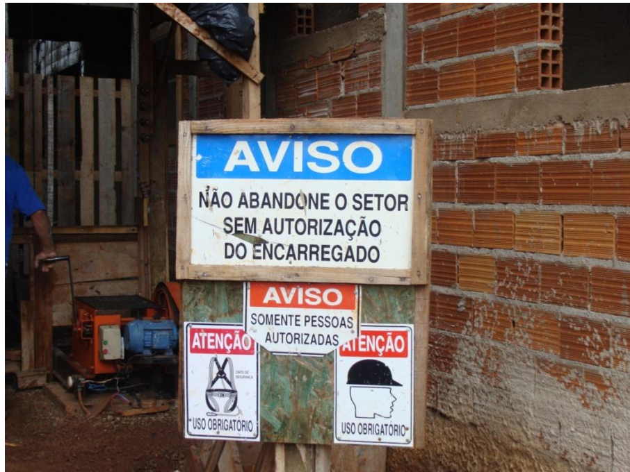
Figura 35 - Sinalização de Segurança Fonte: Edilene Cristina Gribeler, 2012
