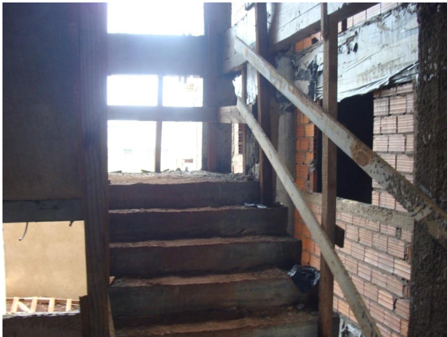
Figura 33 - Escada Sem Proteção e Rodapé Fonte: Edilene Cristina Gribeler, 2012
