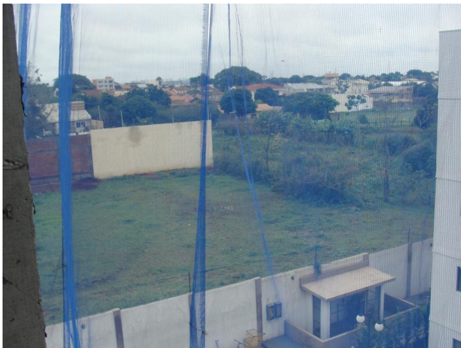
Figura 21 - Telas de Proteção Lateral Fonte: Edilene Cristina Gribeler, 2012
