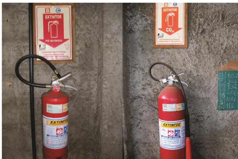
Figura 13 – Extintores de Incêndio.
