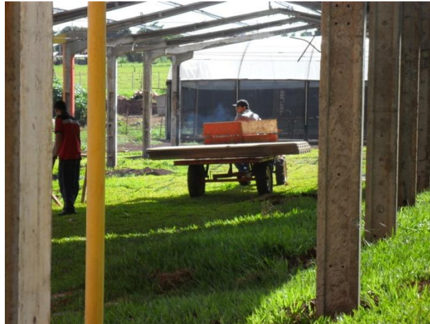
Fotografia 39: trabalhadores transportando e descarregando placas de concreto sem a utilização de EPI's.
