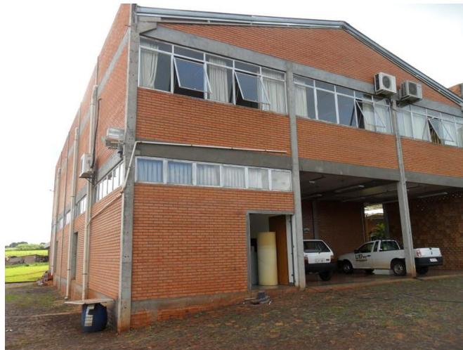
Fotografia 4: Vista pela lateral esquerda do Bloco onde funciona a Divisão de Manutenção.
