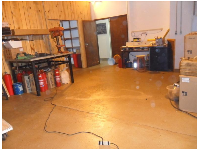
Fotografia 21: extensão elétrica utilizada para funcionamento de maquinários e equipamentos na área externa da divisão de manutenção.
