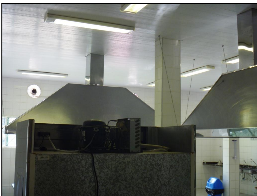
Figura 11 – Sistemas de exaustão artificial utilizados na Cozinha do Hospital Municipal
